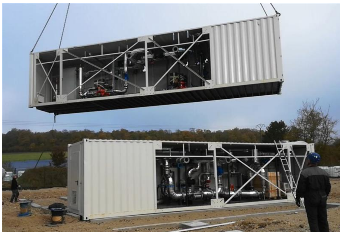
Abbildung 15: Vormontierte/-geprüfte Solarstation DN150 in Containerbauweise
