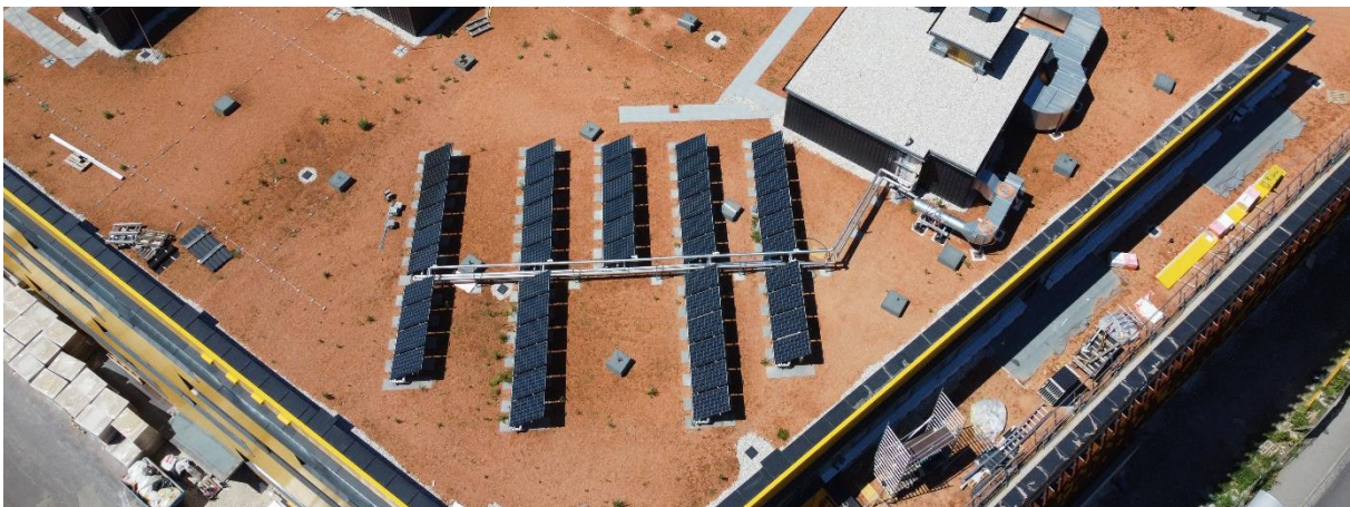
Abbildung 1: installierte PVT-Anlage am Dach des Nebengebäudes (Quelle:Schachermayer GmbH)
