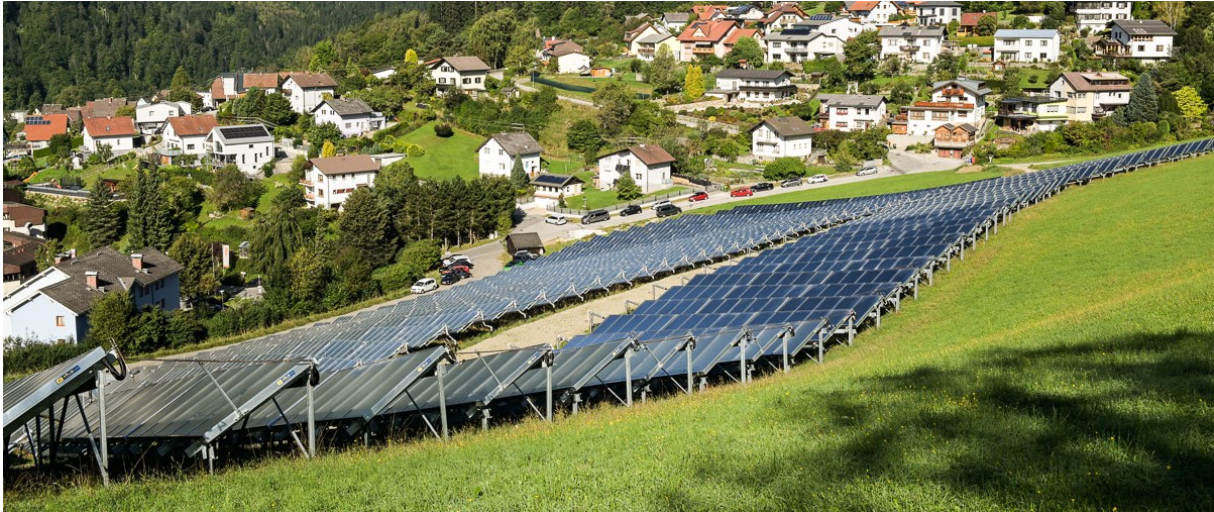
Abbildung 1: Bestehendes Kollektorfeld (Hintergrund) und Erweiterung (Vordergrund). (Quelle: SOLID GmbH)
