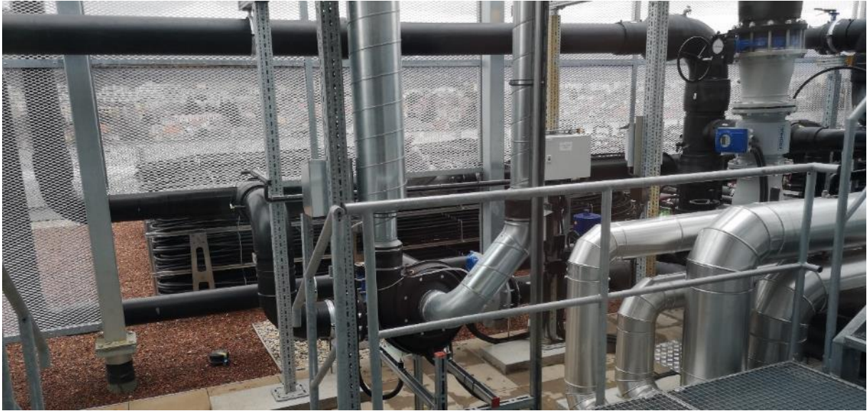
Abbildung 1: Anlagentechnik am Dach, mit Solarabsorbern im Hintergrund (Quelle: AEE INTEC)
