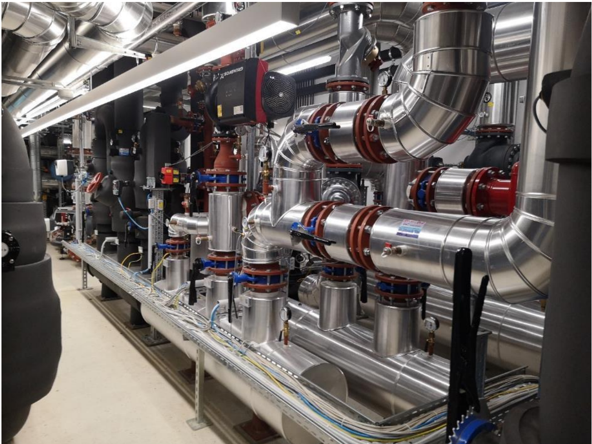
Abbildung 2: Anlagentechnik im Betriebsraum (Quelle: AEE INTEC)
