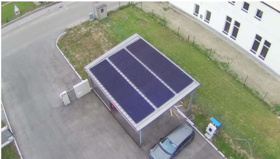
USV + Energiespeicher Schuppen – 18 Module -440Wp
