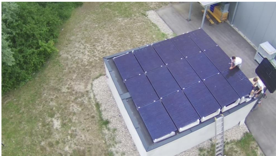
Garage – Segeldach – 15 Module – 440 Wp
