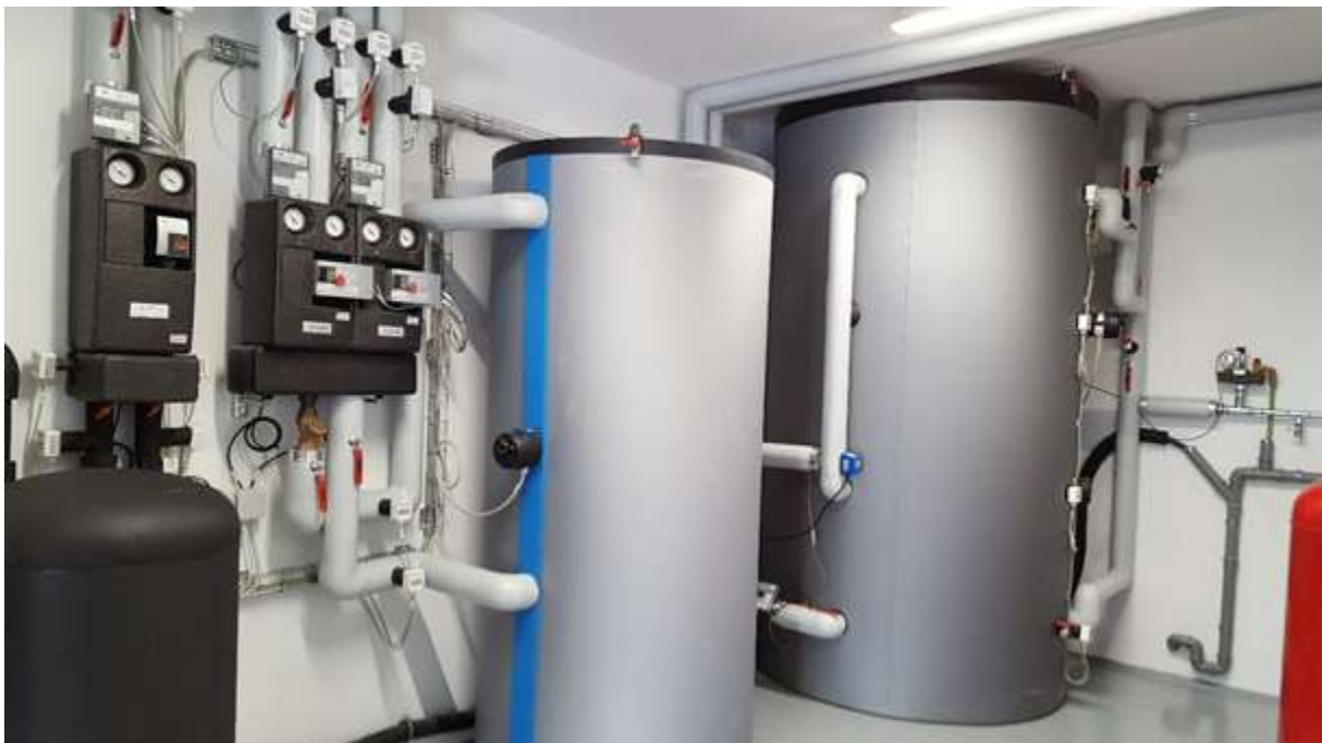
Abbildung 10: Ansicht Technikraum (links: Solarprimärpumpengruppe mit Solarwärmetauscher, sowie Raumheizungsverteiler mit Pumpengruppen; Mitte: Heizungspuffer; rechts: Warmwasser-Puffer) (Quelle: AIT)
