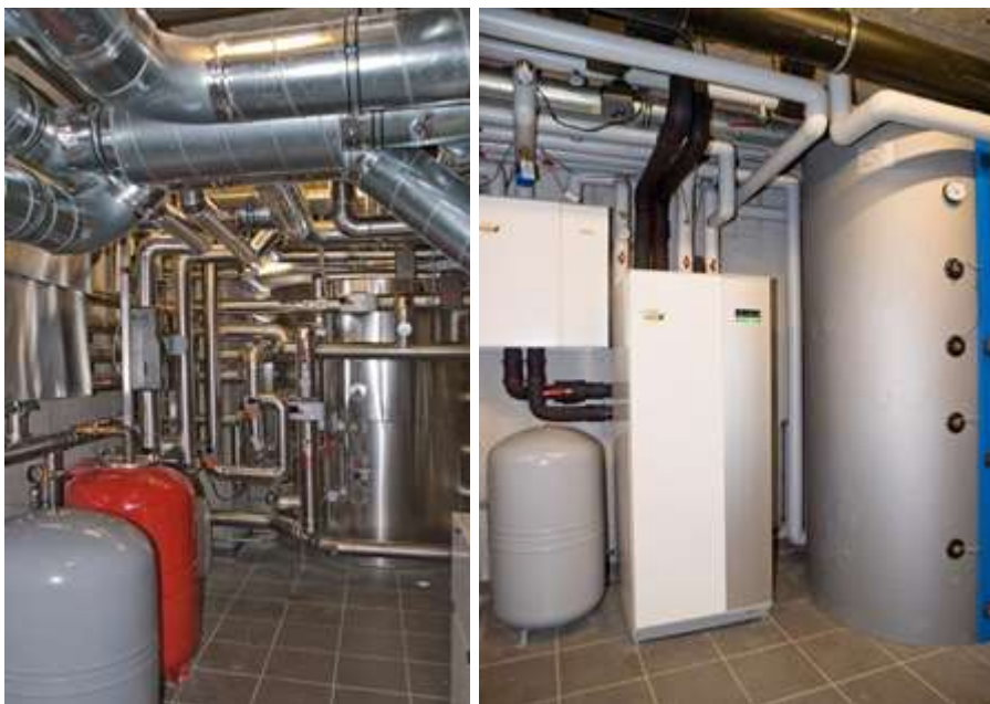
Abbildung 111: Ansicht des neu gebauten Technikraums ALWI Solarbüro (Quelle: FIN - Future is Now GmbH)
