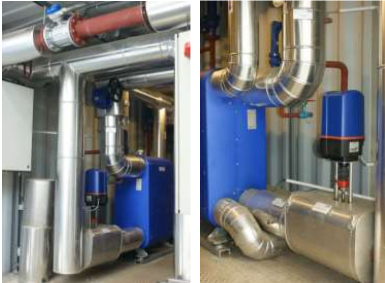
Abbildung 100: Blick in den Technikcontainer und Ansicht der beiden Umwälzpumpen sowie der beiden Wärmetauscher der Anlage (Bildquelle: AEE INTEC).
