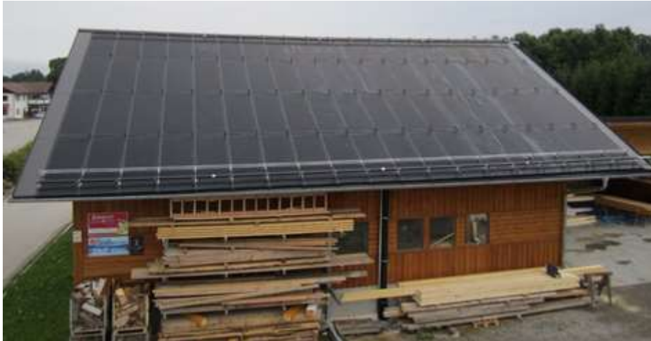
Abbildung 82: Nebengebäude der Nahwärme Danzermühle mit unabgedeckten Flachkollektoren.
