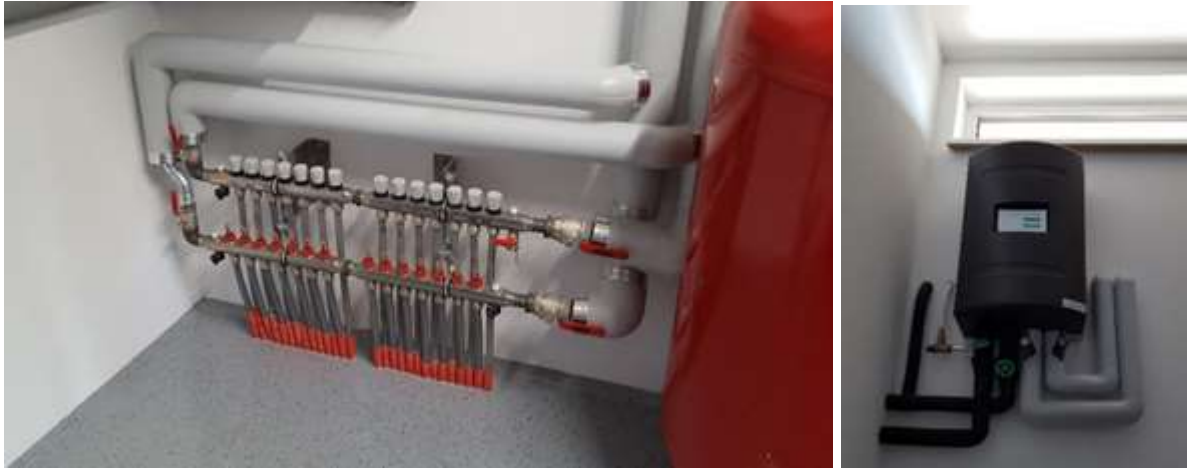
Abbildung 11: Verteiler Betonkernaktivierung und Frischwasserstation Umkleide (rechts) (Quelle: AIT)
