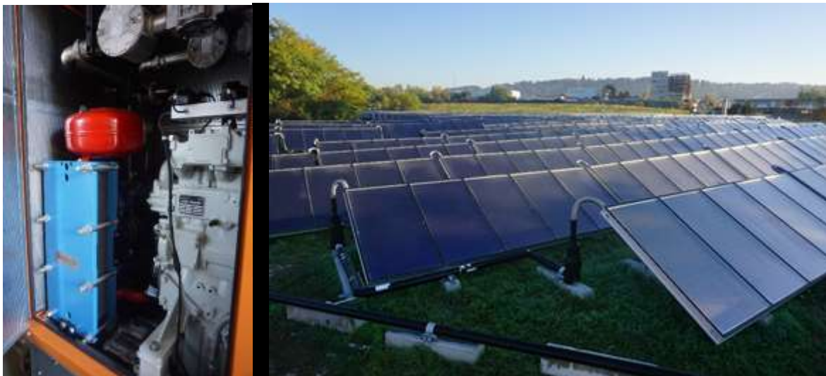
Abbildung 147: Deponiegas-BHKW (links) und Kollektorfelder (rechts) (Quelle: AEE INTEC)
