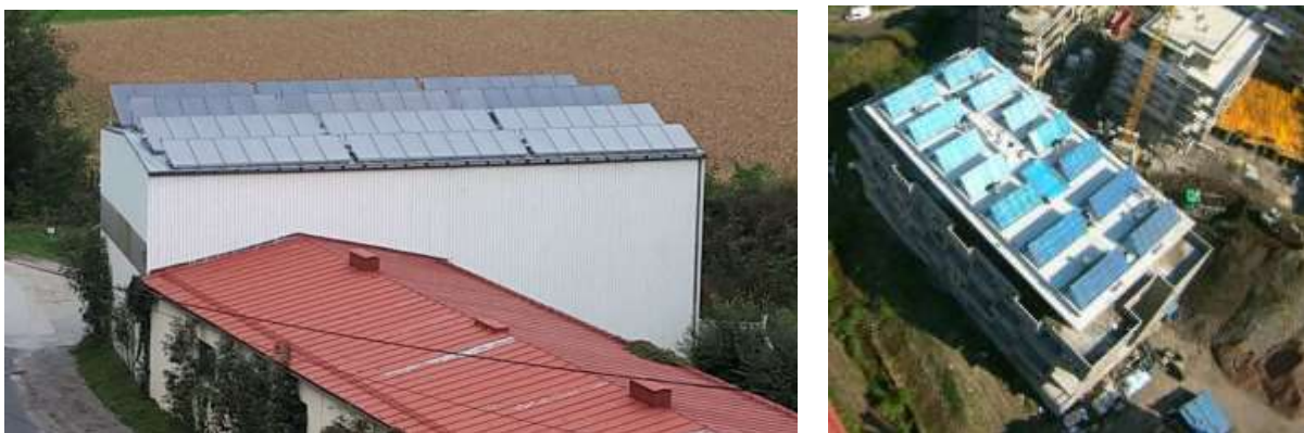
Abbildung 136: Ansicht zweier Kollektorfelder auf den Mehrparteienhäusern des Projekts „Energieinsel Landskron“ (Bildquelle: asteenergy)
