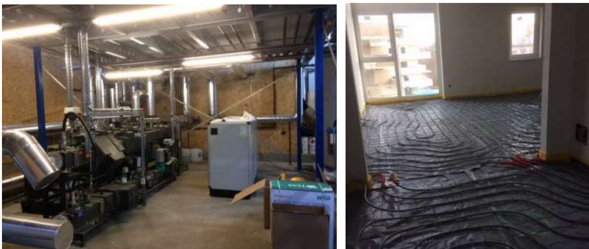
Abbildung 137: Ansicht der Heizzentrale (linke Abbildung) sowie Abbildung der Fußbodenheizungen während der Verlegearbeiten (rechte Abbildung) des Projekts „Energieinsel Landskron“ (Bildquelle: asteenergy)
