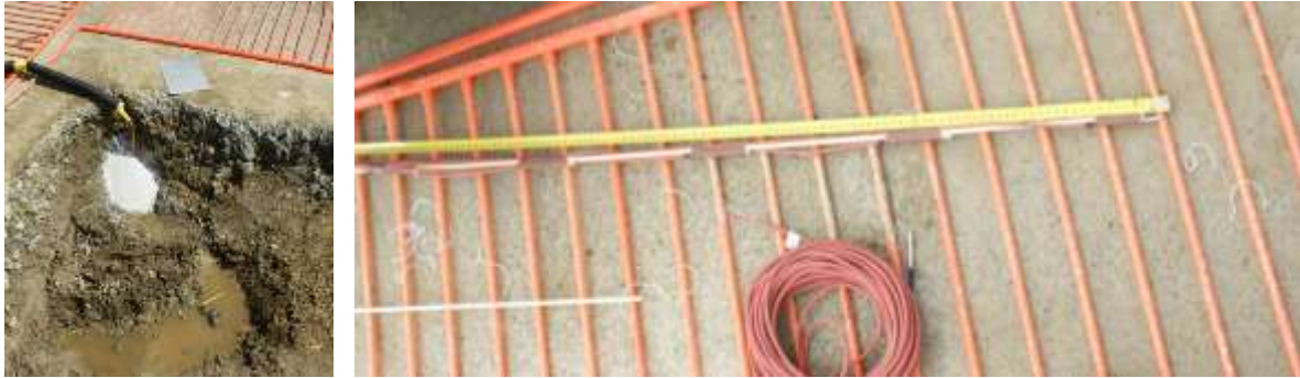
Abbildung 46: Darstellung der in einem 2 Meter tiefen Bohrloch unter dem Erdspeicher vertikal eingebrachten, mit Temperaturfühlern belegten Messbaums (Bildquelle: AEE INTEC).
