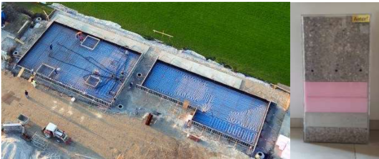
Abbildung 7: Linkes Bild: Ansicht der Heizrohre zur Betonkernaktivierung während der Errichtung. Rechtes Bild: Querschnitt der Betonkernaktivierung als Modell ausgestellt. Quellen: http://www.kuster.co.at
