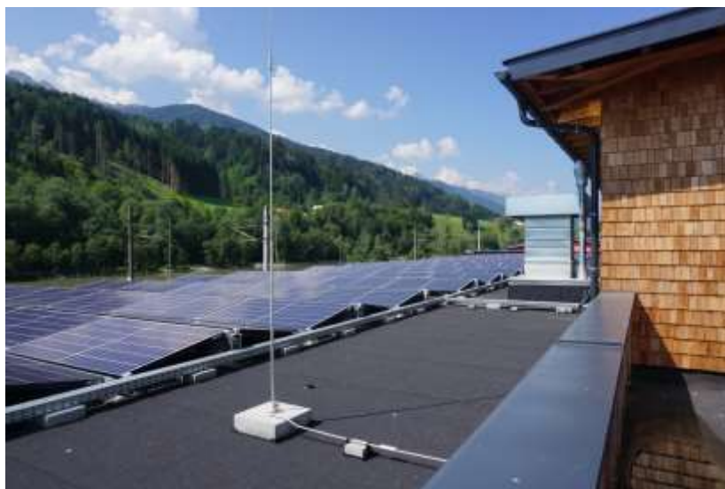
Abbildung 160: Am Flachdach der Werkstatt montierte 50 kWp PV-Anlage (Bildquelle: AEE INTEC)
