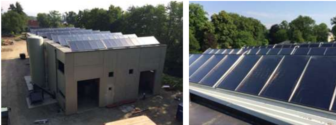
Abbildung 63: Ansicht des Regionalwärmehauses Ebenthal mit den aufgeständerten Kollektoren am Dach des Heizhauses (Quelle: QM-Baubericht, BC Regionalwärme Ebenthal)
