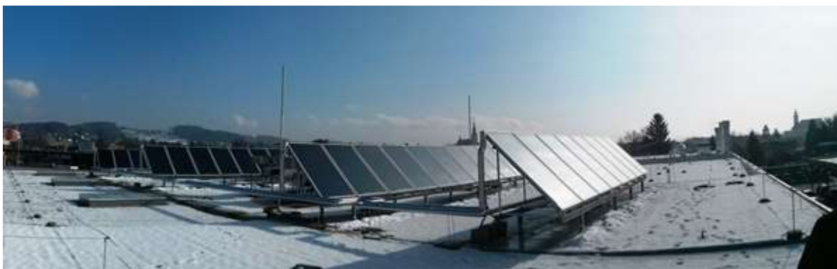
Abbildung 43: Ansicht der am Dach des Autohauses aufgeständerten Kollektoren (Bildquelle: AEE INTEC)
