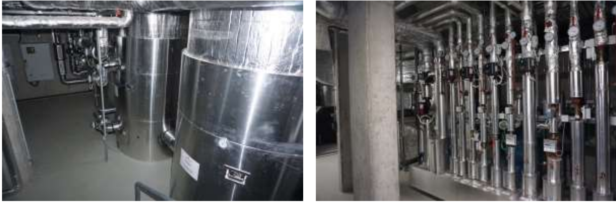
Abbildung 153: Technikraum der Sporthalle Lieferung (Bildquelle: AEE INTEC)
