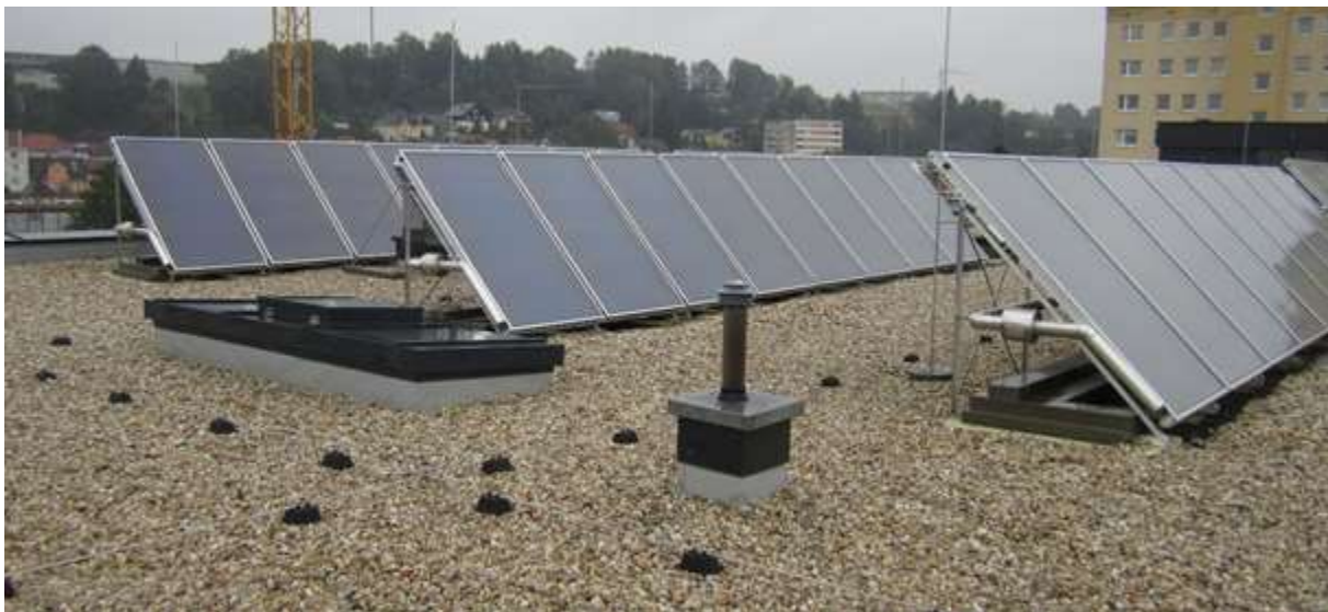
Abbildung 117: Kollektorfeld auf dem Flachdach des DLZ Grieskirchen. Quelle: AIT
