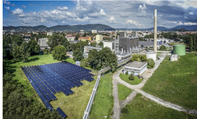
Abbildung 45: Im Zuge einer solaren Integration ins Grazer Fernwärmenetz werden in einem Teilkollektorfeld mit 2.490m 2 Bruttokollektorfläche fünf unterschiedliche 2-fach abgedeckte Flachkollektoren in parallelen Strängen betrieben (Bildquelle: Picfly.at Thomas Eberhard)
