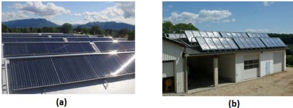
Abbildung 16: (a) Pumpenfabrik Kral, Vbg. (553 m 2 , 15m 3 , SD: 72%, SE: 487 kWh/m 2 a SPF el. : 4,5; SPF th. : 0,6). (b) Obstsaftproduktion Krspel (100 m 2 , 20m 3 Wasserspeicher, SD: 30%, SE: 374 kWh/m 2 a SPF el. : 3,5; SPF th. : 0,4); alle Bildquellen: AEE INTEC
