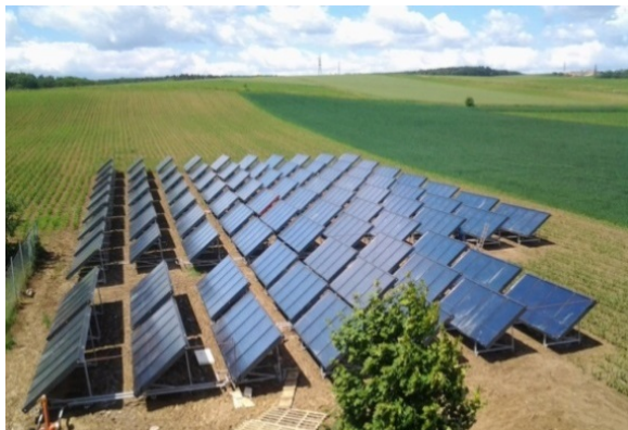
Abbildung 52: Ansicht der bodenmontierten 1.067 m 2 großen Kollektorfläche (Bildquelle S.O.L.I.D.)
