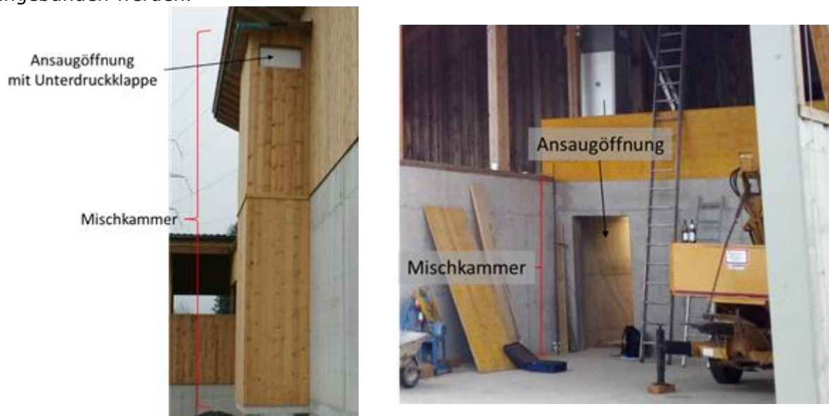
Abbildung 48: Mischkammern und Ansaugöffnungen (Bildquellen: AEE INTEC)
