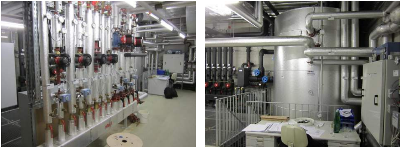
Abbildung 32: Heizungsverteiler und Nahwärmeübergabestation (linkes Bild), Pufferspeicher, der über zwei Etagen reicht, sowie Kälteverteiler im Technikraum der Anlage „Sozialzentrum Rankweil“ (rechtes Bild)
