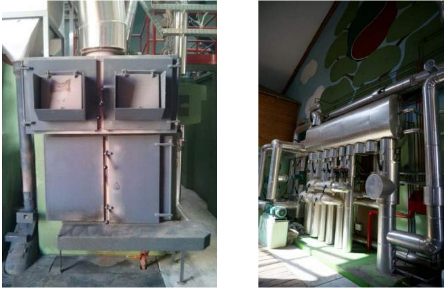
Abbildung 65: Ansicht des Wärmeverteilers (links) und Ansicht des kleineren der beiden Hackgutkessel (700 kW, rechts) der Anlage "Nahwärme Eibiswald", Bildquelle: AEE INTEC
