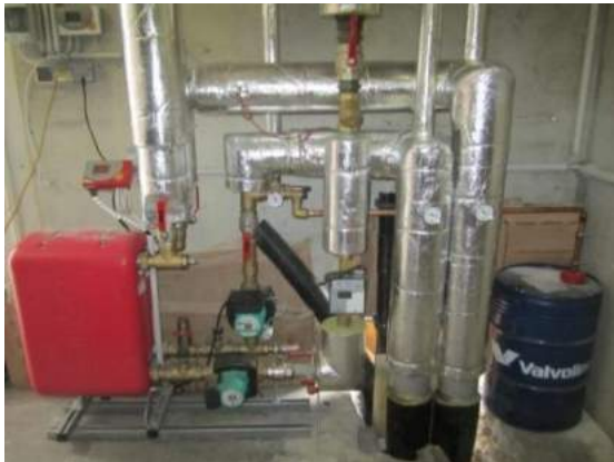
Abbildung 203: Solarwärmetauscher, Umwälzpumpen im Solarsekundär- und -primärkreis, Wärmezähler im Solarsekundärkreis sowie Anschluss an erdverlegte Leitungen zu den Kollektoren. Quelle: AIT
