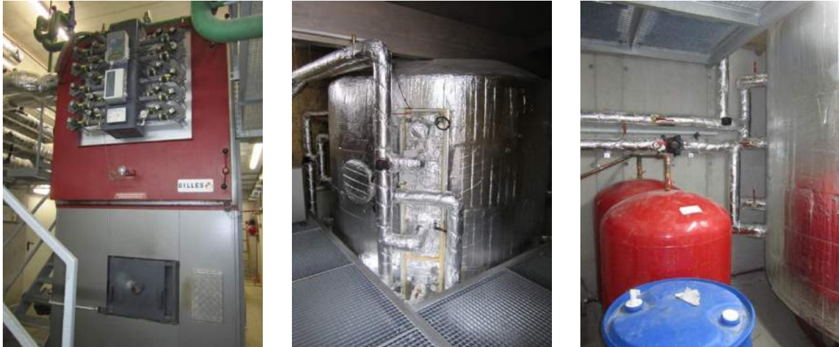
Abbildung 131: Hackgutkessel im Biomasseheizwerk Mühldorf (linkes Bild); oberer Teil (mittleres Bild) und unterer Teil des Puffers sowie Ausdehnungsgefäße und Sammelbehälter im Kindergarten Scharnstein
