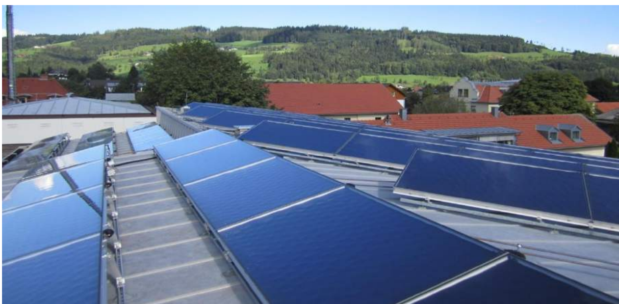
Abbildung 127: Nach Südwesten (links) und Süd-Südosten (rechts) orientierte Flachkollektorfelder auf den verschiedenen Dachteilen des Amtshauses Scharnstein
