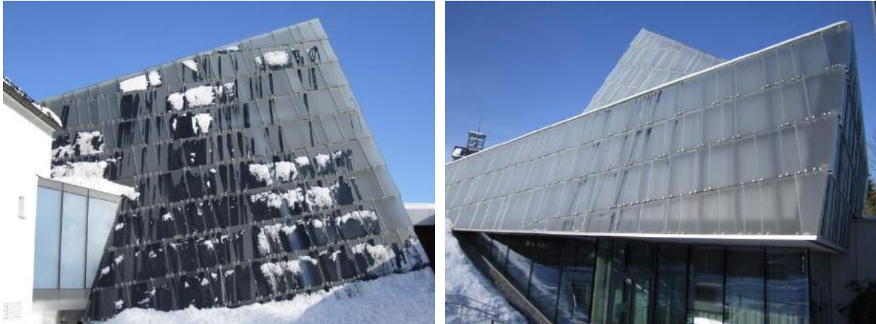
Abbildung 167: Ansicht des nach Westen ausgerichteten Kollektorfeldes (linkes Bild) und des nach Süden ausgerichteten Kollektorfeldes (rechtes Bild), jeweils hinter der Glasfassade montiert
