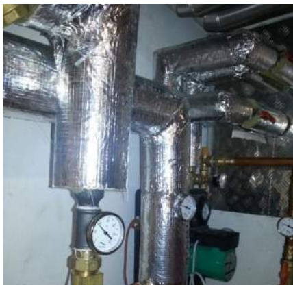
Abbildung 138: Pumpen, Armaturen und wärmegeädämmte Rohrleitungen
