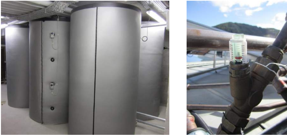
Abbildung 134: Linkes Bild: Sechs parallel geschaltete Pufferspeicher im Amtshaus Scharnstein; Rechtes Bild: Abgleichventil im Solarprimärkreis
