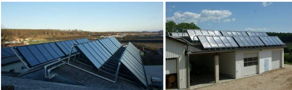
Abbildung 80: Ansicht des Kollektorfeldes der Anlage „Obstsaftproduktion Krispel“, Bildquelle: AEE INTEC
