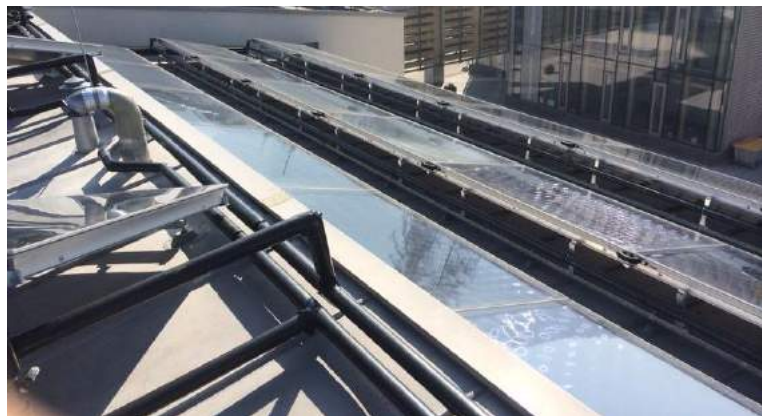
Abbildung 139: Kollektorfeld mit wärmegeädämmten Rohrleitungen
