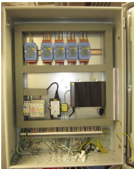
Abbildung 135: Monitoring-Box mit Eingangsbaugruppen (oben) und Industrie-PC (rechts)
