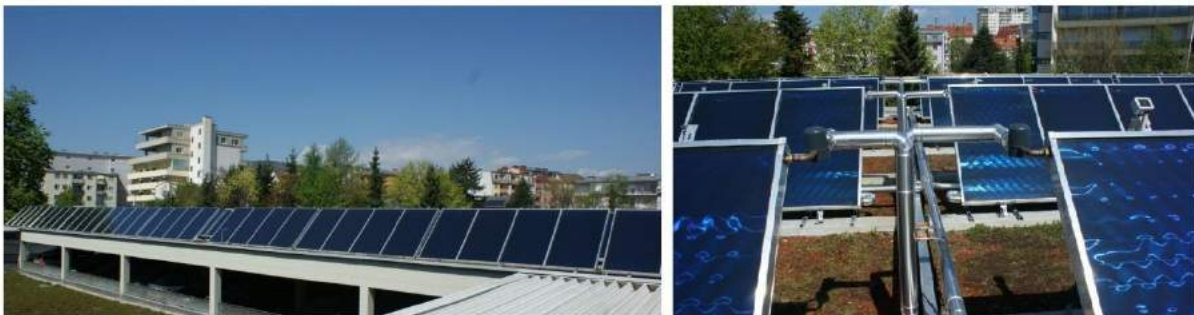
Abbildung 51: Ansicht Kollektorfeld der Anlage „Krankenhaus der Elisabethinen“, Bildquelle: AEE INTEC
