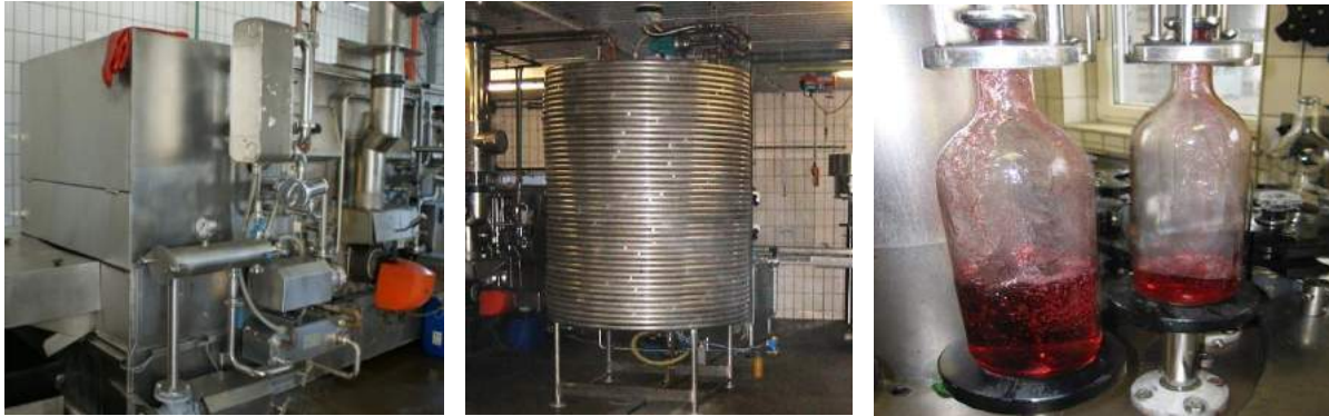
Abbildung 81: Ansicht der Flaschenwaschmaschine, des Rohrwärmetauschers (Safterwärmung und -kühlung) sowie der Abfüllanlage der Anlage „Obstsaftproduktion Krispel“, Bildquelle: Krispel
