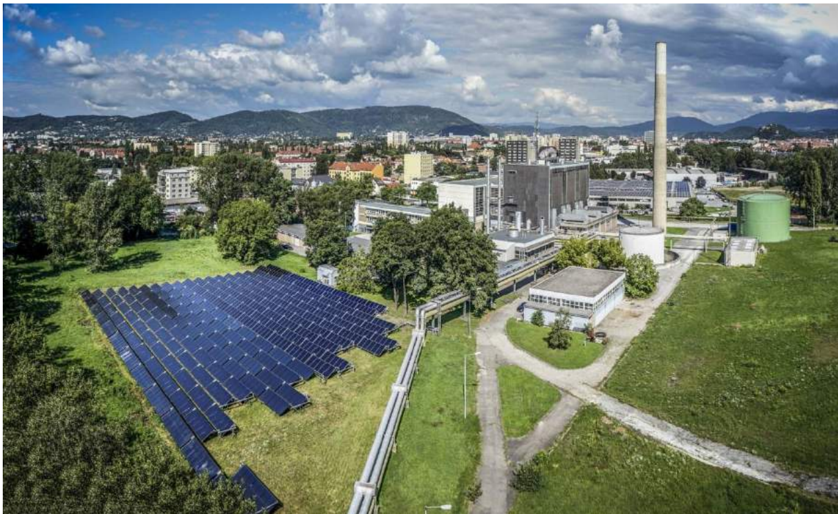
Abbildung 154: Ansicht des Kollektorfeldes auf dem Gelände des Fernheizwerks Graz im Vordergrund. Im Hintergrund ist das Fernheizwerk inkl. Kesselhaus erkennbar. Rechts neben dem Kollektorfeld ist die Fernwärmeleitung zwischen dem Kraftwerk Mellach sowie dem Standort des Fernheizwerks in der Graz-Puchstraße erkennbar (Bildquelle: Picfly.at Thomas Eberhard)
