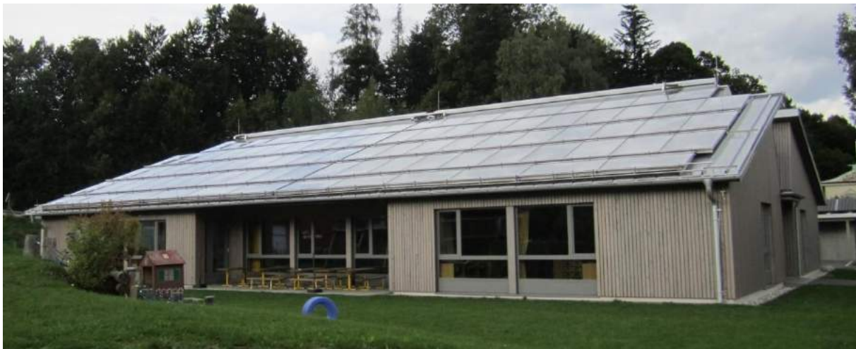
Abbildung 132: Flachkollektoren auf dem Dach des Kindergartens Scharnstein
