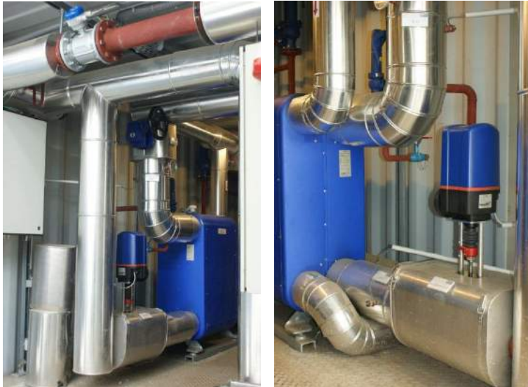
Abbildung 155: Blick in den Technikcontainer und Ansicht der beiden Umwälzpumpen sowie der beiden Wärmetauscher der Anlage.
