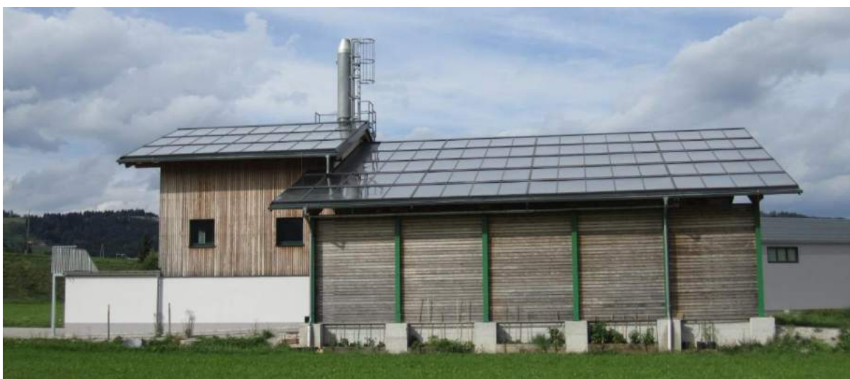
Abbildung 130: Indach-Solarthermiekollektoren auf dem Dach des Biomasseheizwerks Mühlendorf
