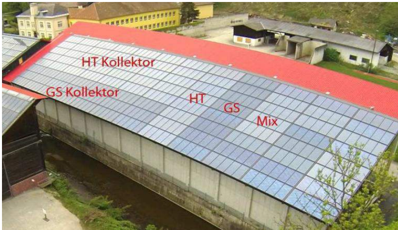
Abbildung 63: Hydraulische Kombination der 1- und 2-fach abgedeckten Flachkollektoren. HT Kollektor steht dabei für einen 2-fach abgedeckten und GS Kollektor für einen 1-fach abgedeckten Flachkollektor (Quelle: Nahwärme Eibiswald)
