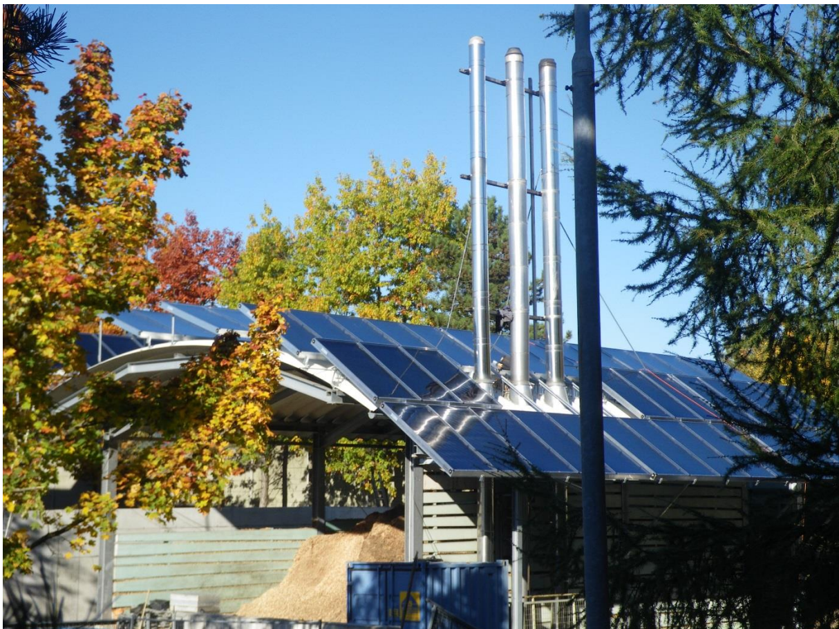
Abbildung 110: Kollektorfeld auf dem Flugdach der Nahwärme Maria Gail. Quelle: NAH-WÄRME Maria Gail
