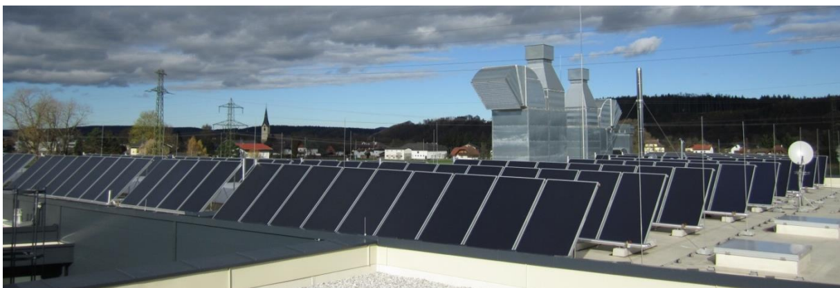
Abbildung 54: Aufständering der Kollektorreihen. Quelle: AIT
