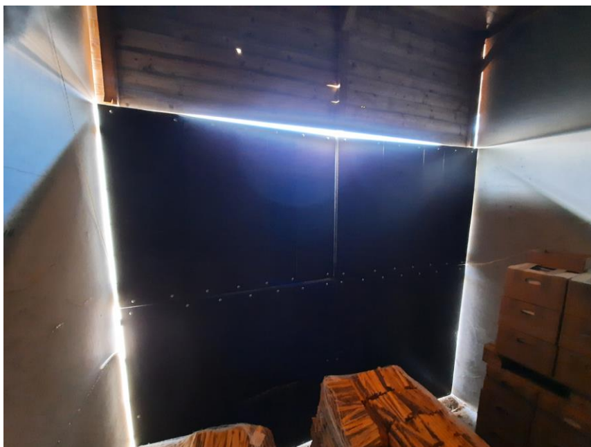
Abbildung 74: Luftspalte zwischen den Wänden und dem Tor einer Trocknungsbox (Quelle: AEE INTEC)
