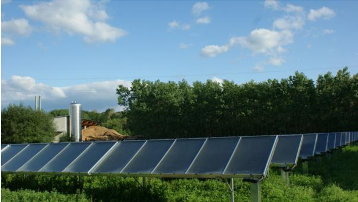
Abbildung 6: Kollektorfeld sowie im Hintergrund der 100 m 3 Pufferspeicher beim Heizwerk Nahwärme St. Ruprecht (Quelle: AEE INTEC)
