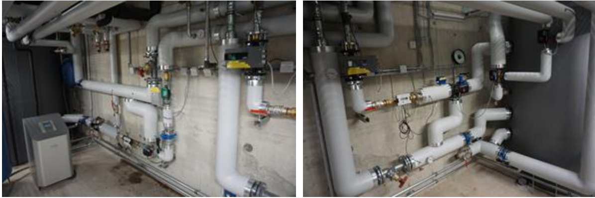
Abbildung 54: Heizraum – warmer (links) und kalter (rechts) Pufferspeicher (Quelle: AEE INTEC)
