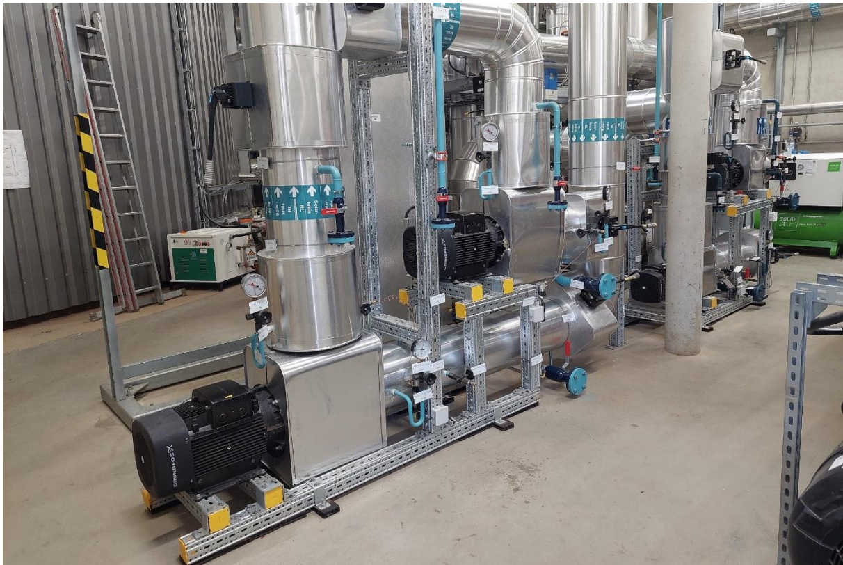
Abbildung 120: Erweiterung der Anlagentechnik, Einbindung Solarenergie. (Quelle: Energie Graz GmbH & Co KG)
