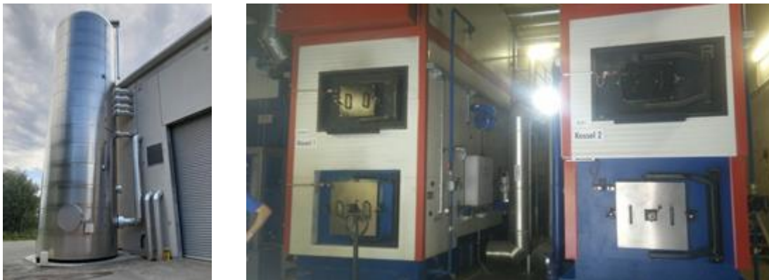
Abbildung 7: neuerrichteter 100 m 3 Solar-Pufferspeicher (links), Hackgutkessel 1 und 2 (rechts) (Quelle: AEE INTEC)
