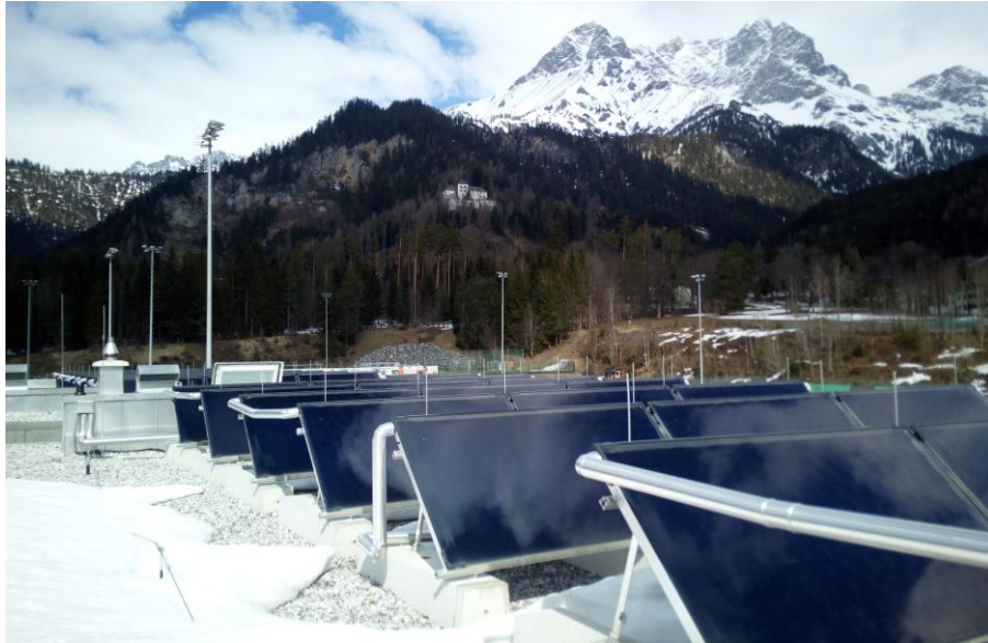
Abbildung 23: Solaranlage am Dach (Quelle: AEE INTEC)
