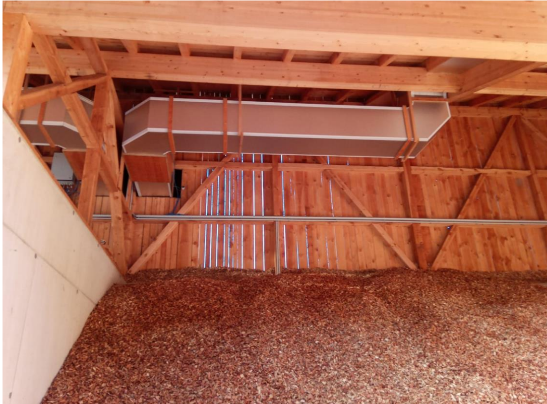
Abbildung 6: Solar-Luftleitungen im Dach der Trocknungshalle (Quelle: AEE INTEC)
