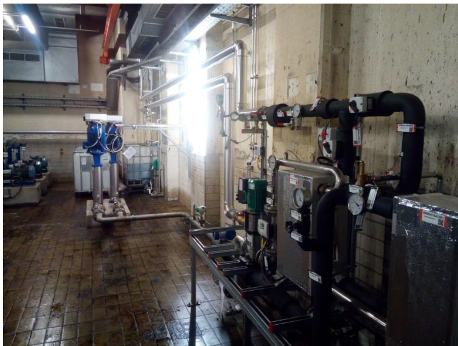
Abbildung 45: Wärmeübergabestation im Technikraum, im Hintergrund sind die Deionat-Einspeisepumpen zu sehen (Quelle: AEE INTEC)
