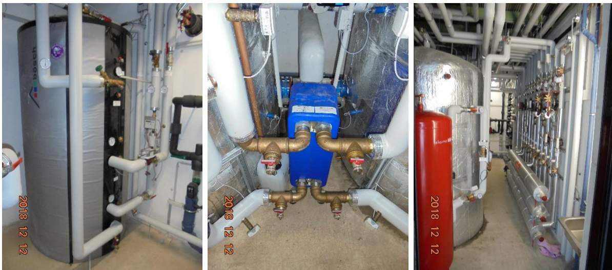
Abbildung 11: Warmwasser-Pufferspeicher (linke Abbildung), Pufferspeicher mit Solarwärmetauscher (mittlere Abbildung) und mit Verteileranlage der Wärmeverbraucher (rechte Abbildung) (Quelle: Stadtamt Saalfelden)
