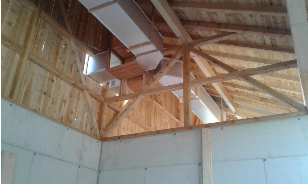
Abbildung 5: Solar-Luftleitungen im Dach der Trocknungshalle (Quelle: Bauherr)
