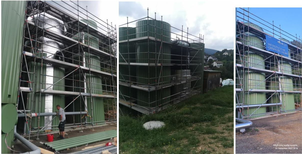
Abbildung 8: Die Pufferspeicher mit je 60m 3 werden vollständig isoliert
