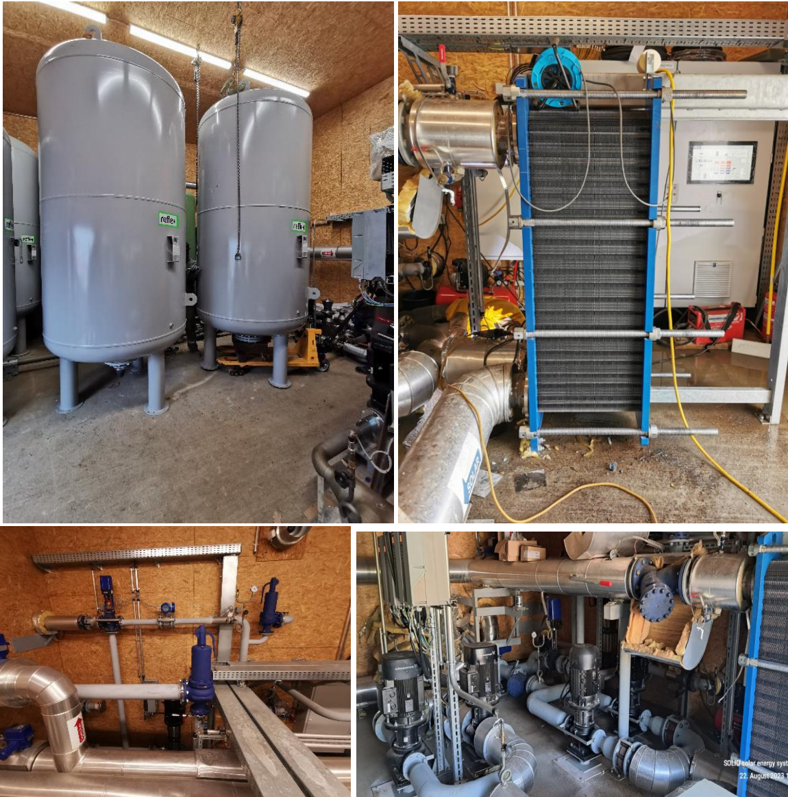
Abbildung 10: Der Innenausbau der Technikzentrale erfolgte parallel zur Errichtung des Solarfeldes. Im Bild sind die Ausdehnungsgefäße, Wärmetauscher und Verrohrung zu sehen.
