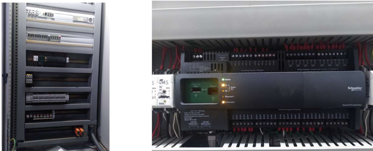
Abbildung 4: Schaltschrank Solar und Smart MPC Server Controller Steuerung
