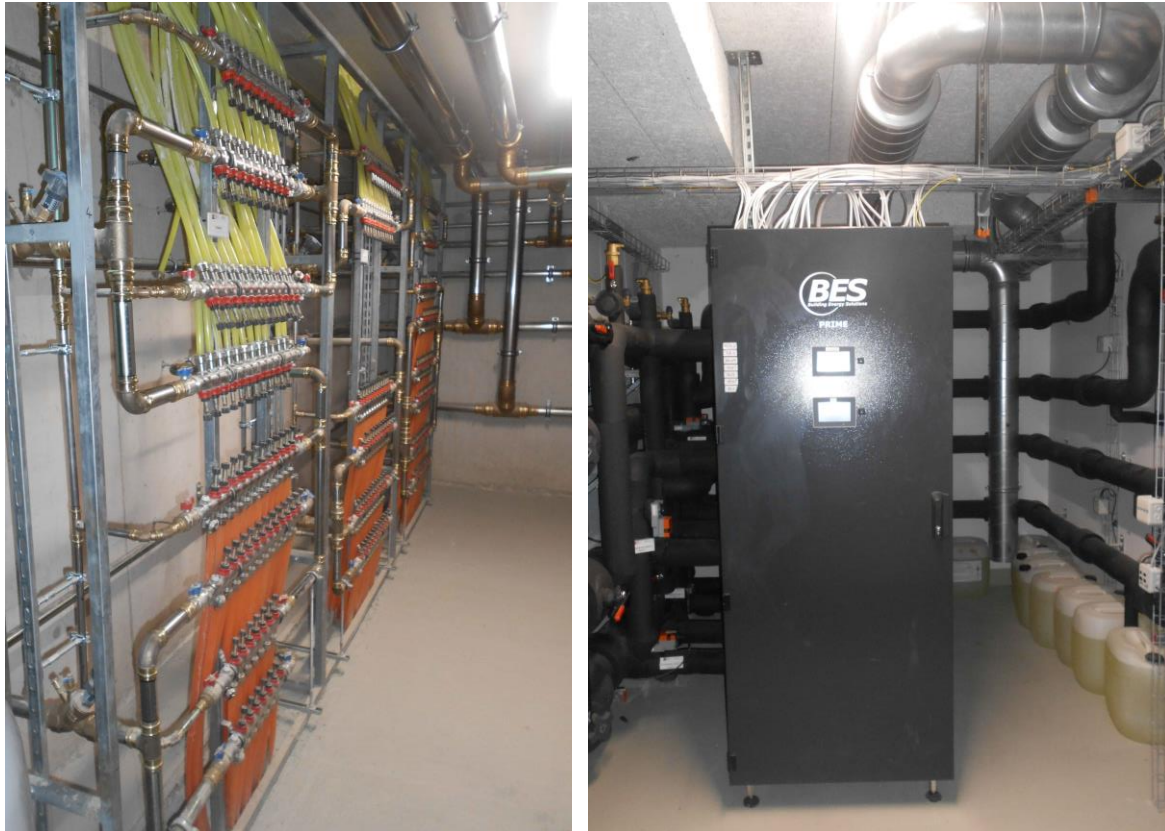
Abbildung 3 Erdspeicherverteiler (links) und Wärmepumpe (rechts)
