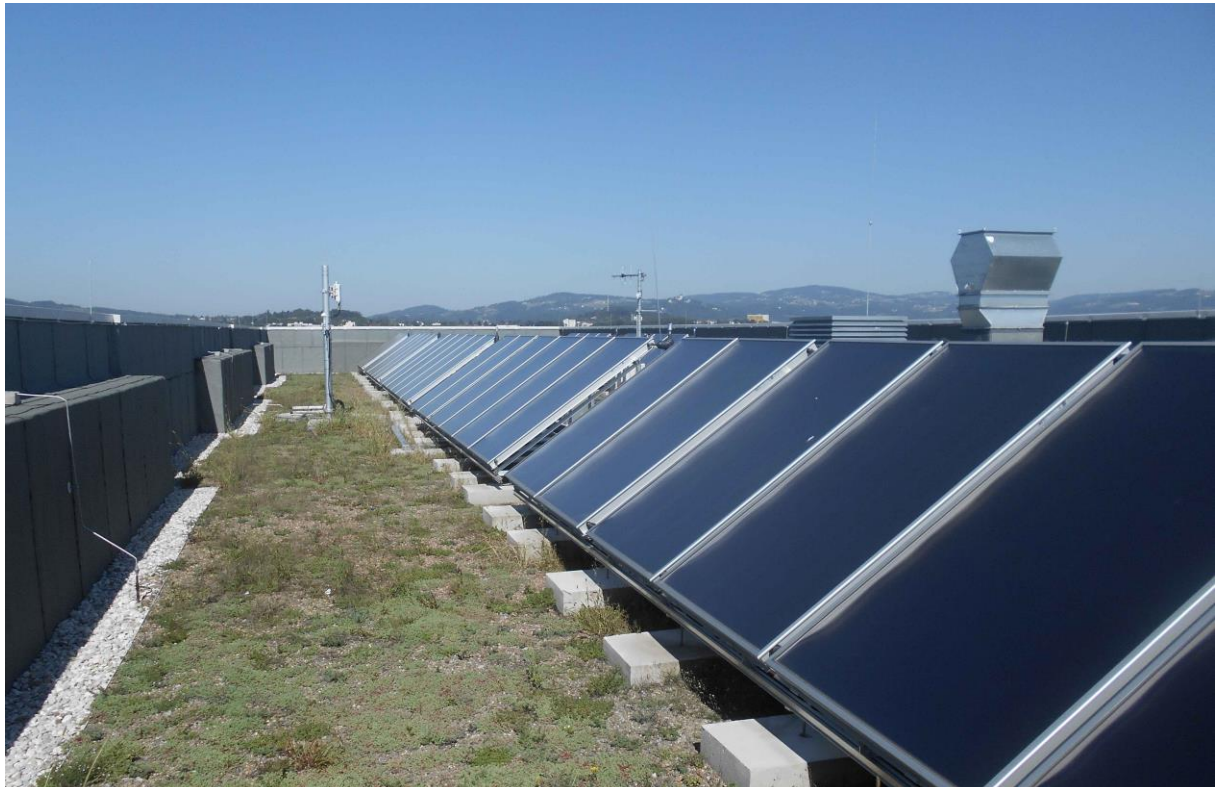
Abbildung 2 Solaranlage am Dach des Gebäudes
