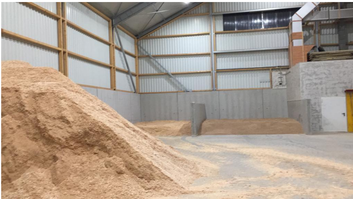
Abbildung 6: Innenraum der Trocknungshalle. Im Hintergrund die beiden Trocknungsroste sowie die Solarleitungen (Quelle: T. Dachs)
