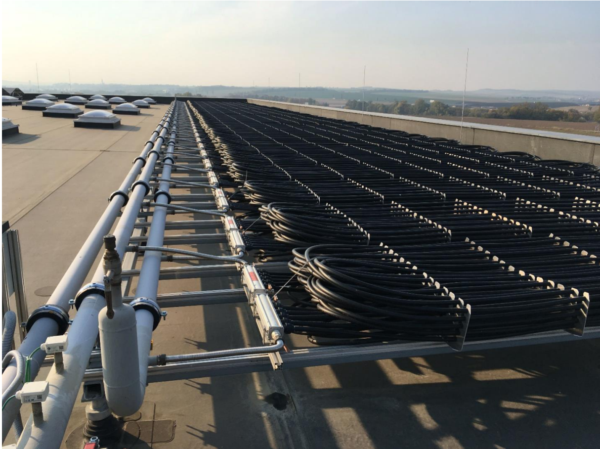
Abbildung 25: Solar-Luft-Kollektor Viessmann SLK-600 (Quelle: Technische Beschreibung des Fördernehmers).
