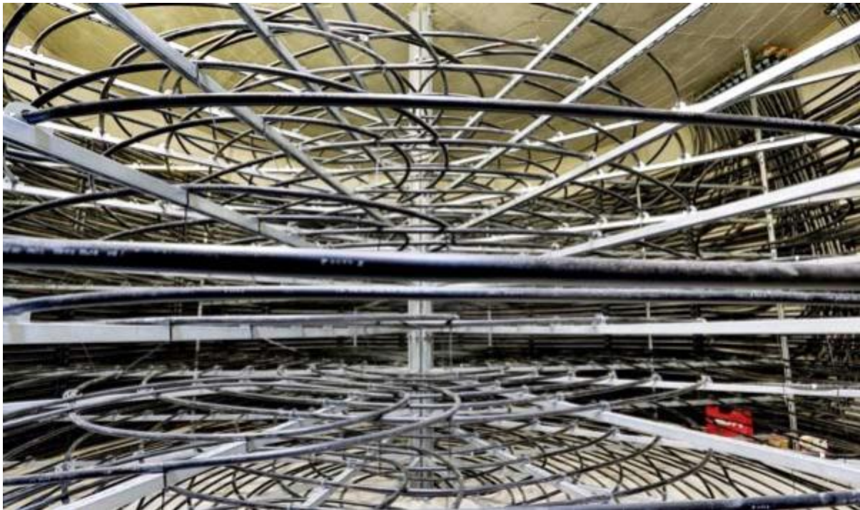
Abbildung 26: Wärmetauscher im Eis-Energiespeicher (Quelle: Technische Beschreibung des Fördernehmers).
