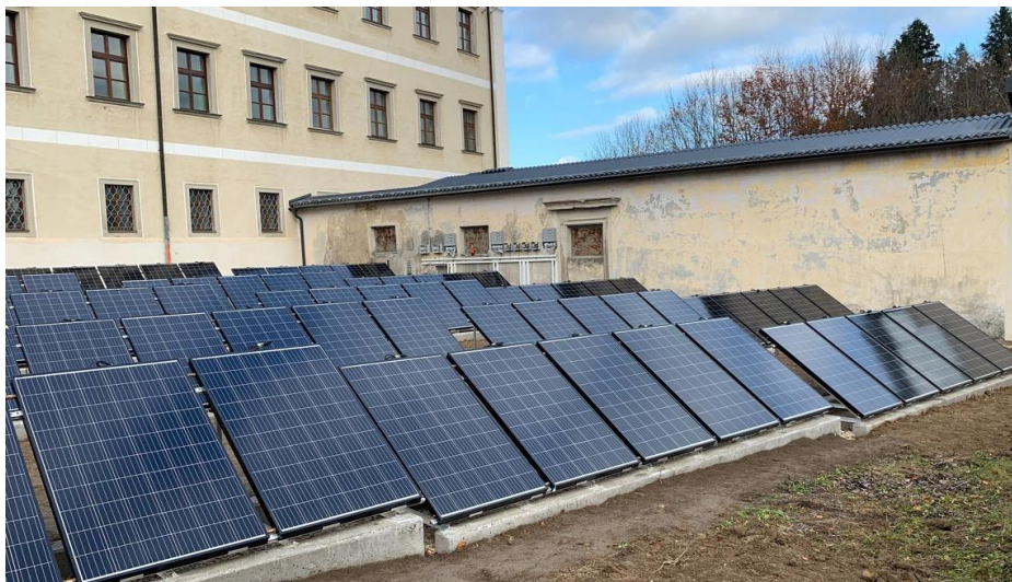
Abbildung 9: Ansicht der am Nebengebäude aufgestellten PVT-Kollektoren (Quelle: BES)
