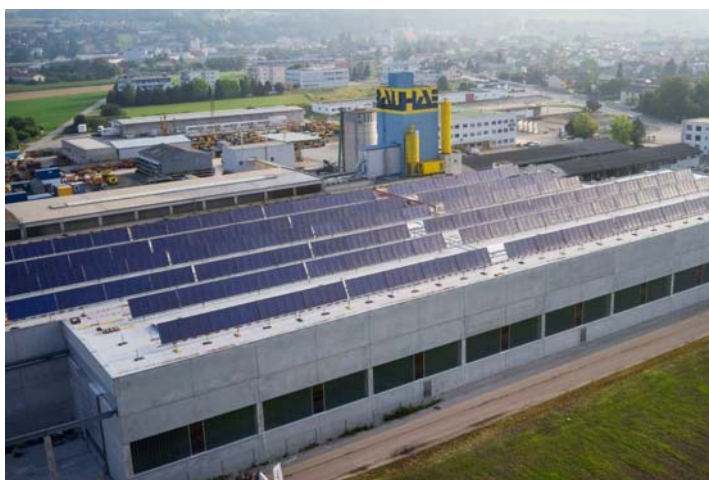
Abbildung 43: Ansicht des Projekts „HABAU Hoch- und Tiefbau GmbH“ mit 1.411 m 2 Bruttokollektorfläche (Bildquelle: www.kuster.co.at)
