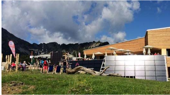
Abbildung 37: Darstellung einzelner Hybridkollektorfelder der Anlage Brandnertal Gastronomie, Vorarlberg. Insgesamt sind 91 m 2 Hybridkollektoren (PVT) und 36 m 2 Flachkollektor installiert. (Bildquelle: Fröod)
