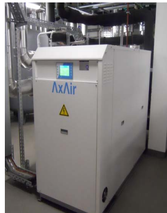
Abbildung 40: Ansicht der 160 kW Kompressionswärmepumpe (Bildquelle: AEE INTEC)
