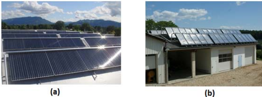
Abbildung 12: (a) Pumpenfabrik Kral, Vbg. (553 m 2 , 15m 3 , SD: 72%, SE: 487 kWh/m 2 a SPF el. : 4,5; SPF th. : 0,6). (b) Obstsaftproduktion Kripel (100 m 2 , 20m 3 Wasserspeicher, SD: 30%, SE: 374 kWh/m 2 a SPF el. : 3,5; SPF th. : 0,4); alle Bildquellen: AEE INTEC
