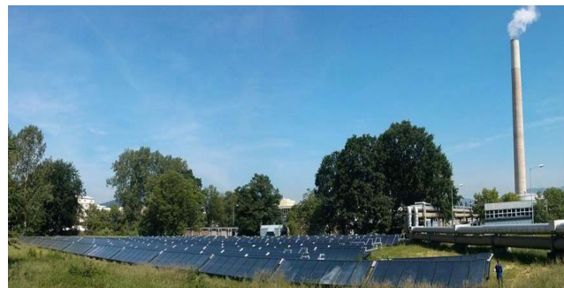
Abbildung 29: Im Zuge einer solaren Integration ins Grazer Fernwärmenetz werden in einer Anlage mit 2.400m 2 Bruttokollektorfläche fünf 2-fach abgedeckte Flachkollektoren in parallelen Strängen messtechnisch untersucht (Quelle: AEE INTEC)
