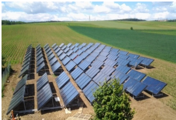
Abbildung 35: Ansicht der bodenmontierten 1.067 m 2 großen Kollektorfläche (Bildquelle S.O.L.I.D.)
