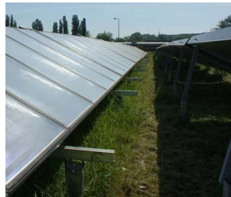
Abbildung 36: Detailansicht zu den im Projekt Fernwärmeeinspeisung Graz (2.400 m 2 ) zum Einsatz gekommenen Rammprofil (Bildquelle AEE INTEC)
