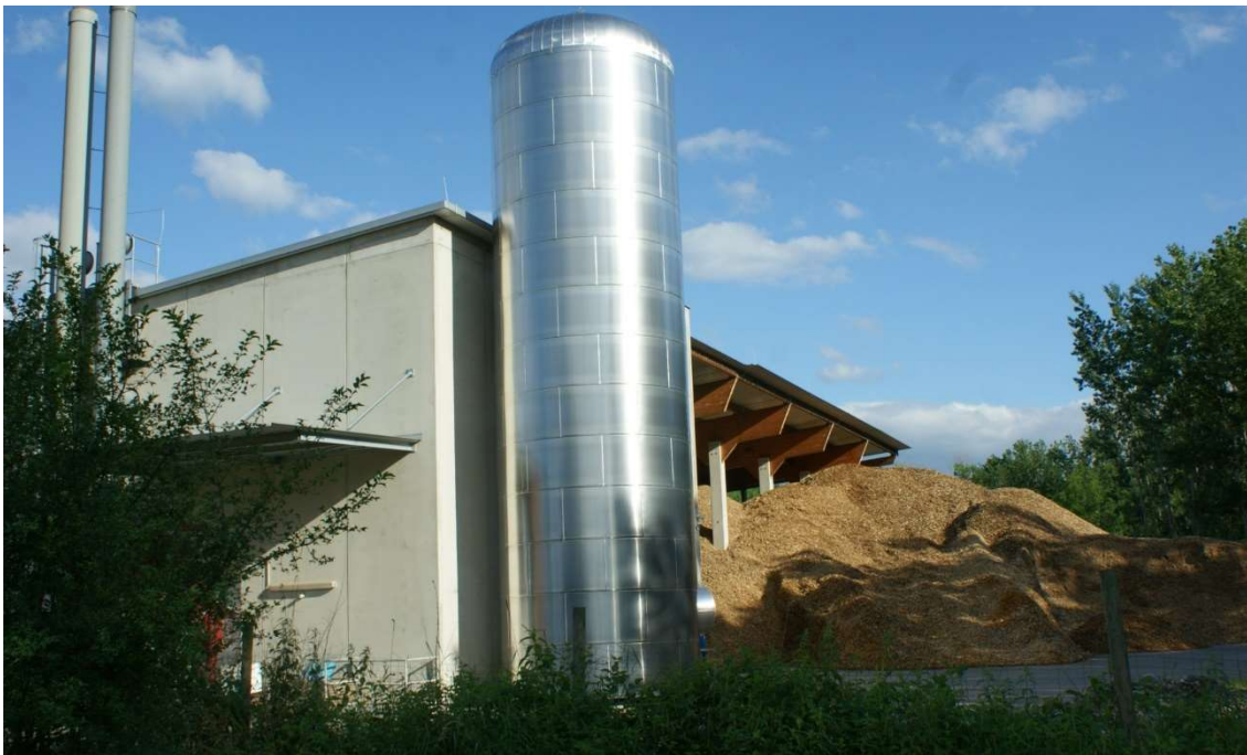
Abbildung 3: Heizwerk inkl. 100 m 3 Pufferspeicher
