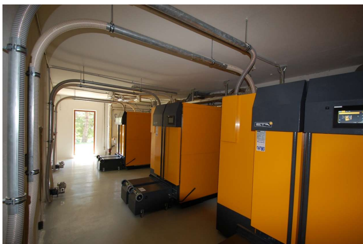
Abbildung 4: Schauheizraum von Innen
