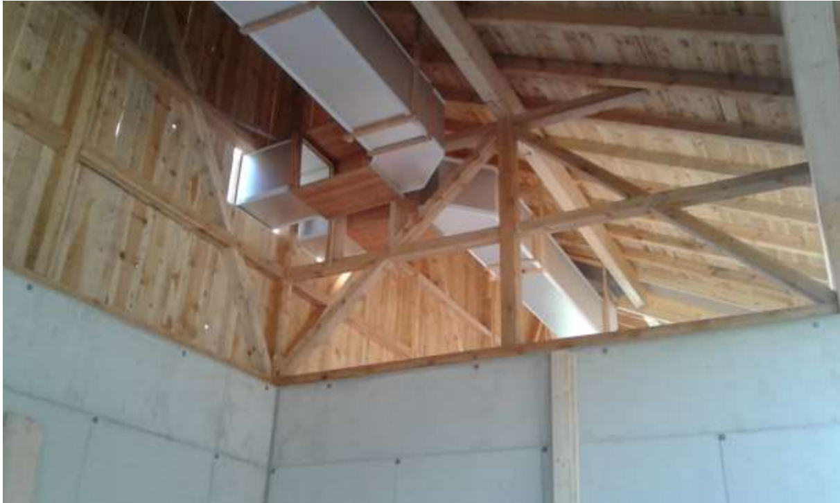
Abbildung 6: Solar-Luftleitungen im Dach der Trocknungshalle (Quelle: Bauherr)
