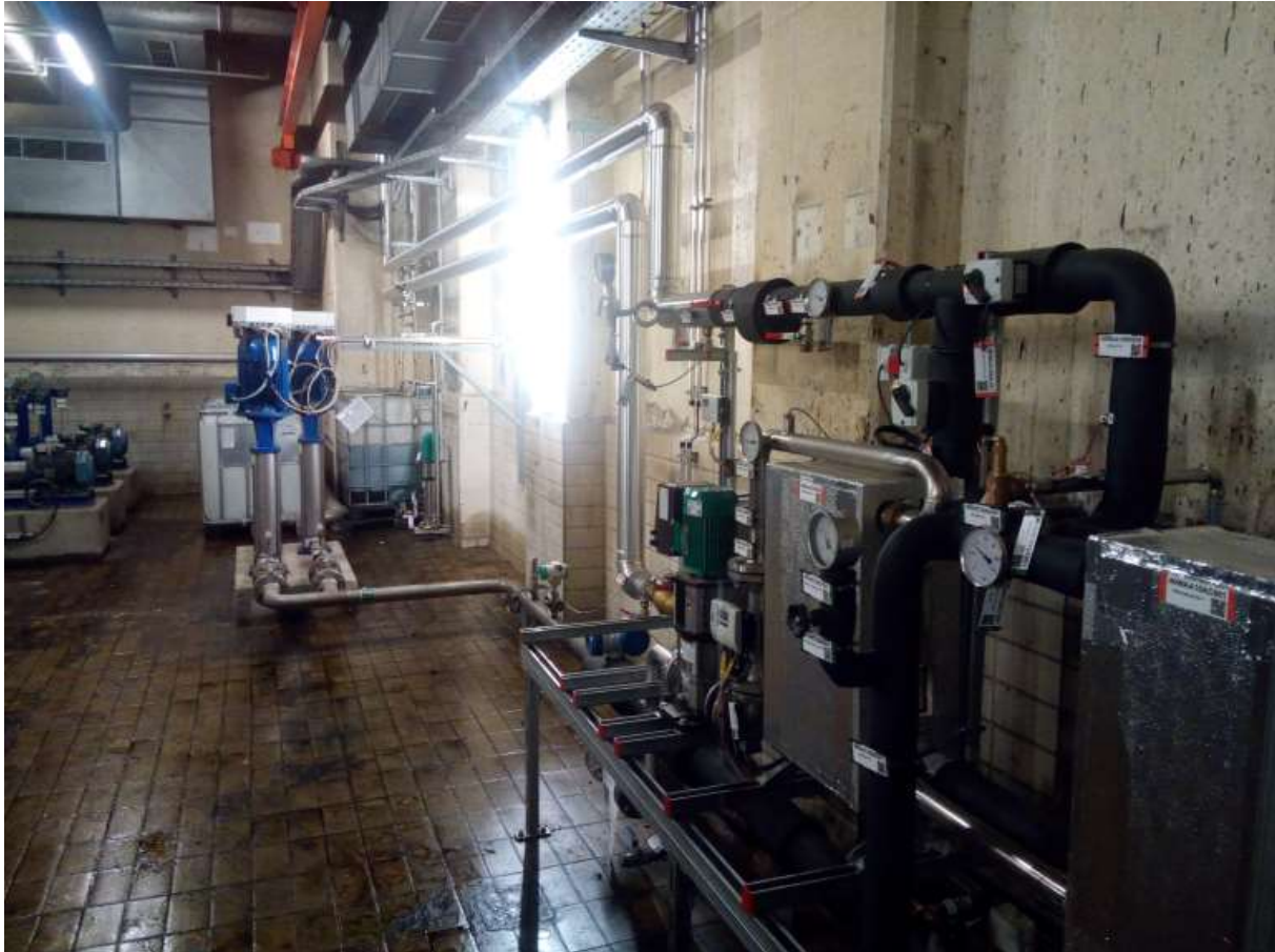
Abbildung 41: Wärmeübergabestation im Technikraum, im Hintergrund sind die Deionat-Einspeisepumpen zu sehen (Quelle: AEE INTEC)
