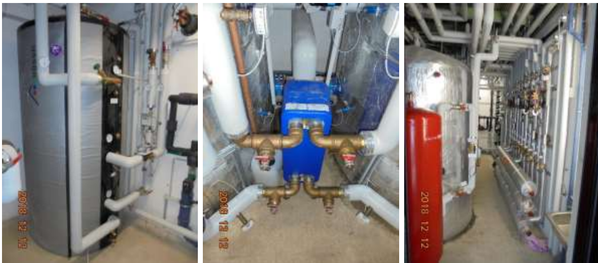
Abbildung 22: Warmwasser-Pufferspeicher (linke Abbildung), Pufferspeicher mit Solarwärmetauscher (mittlere Abbildung) und mit Verteileranlage der Wärmeverbraucher (rechte Abbildung) (Quelle: Stadtamt Saalfelden)
