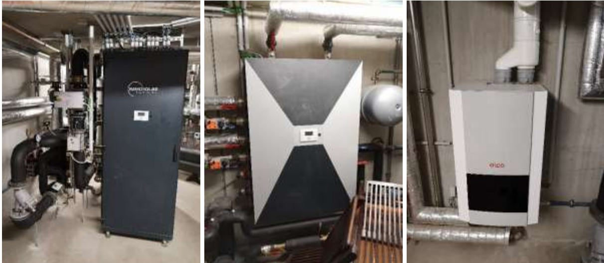
Abbildung 33: Wärmepumpen (links), SCU-Solar Central Processing Unit (mitte) und Gastherme (rechts) im Heizraum (Bildquelle: AEE INTEC)
