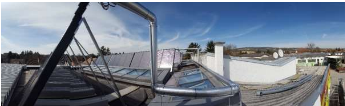
Abbildung 7: Panoramafoto der Solaranlage am Dach (Quelle: AIT)
