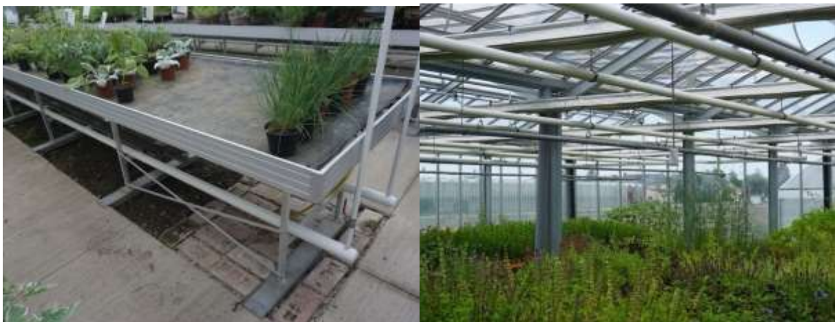
Abbildung 50: Die Nachheizung in den Gewächshäusern: Untertisch- (links) und Oberheizung (rechts) (Quelle: AEE INTEC)
