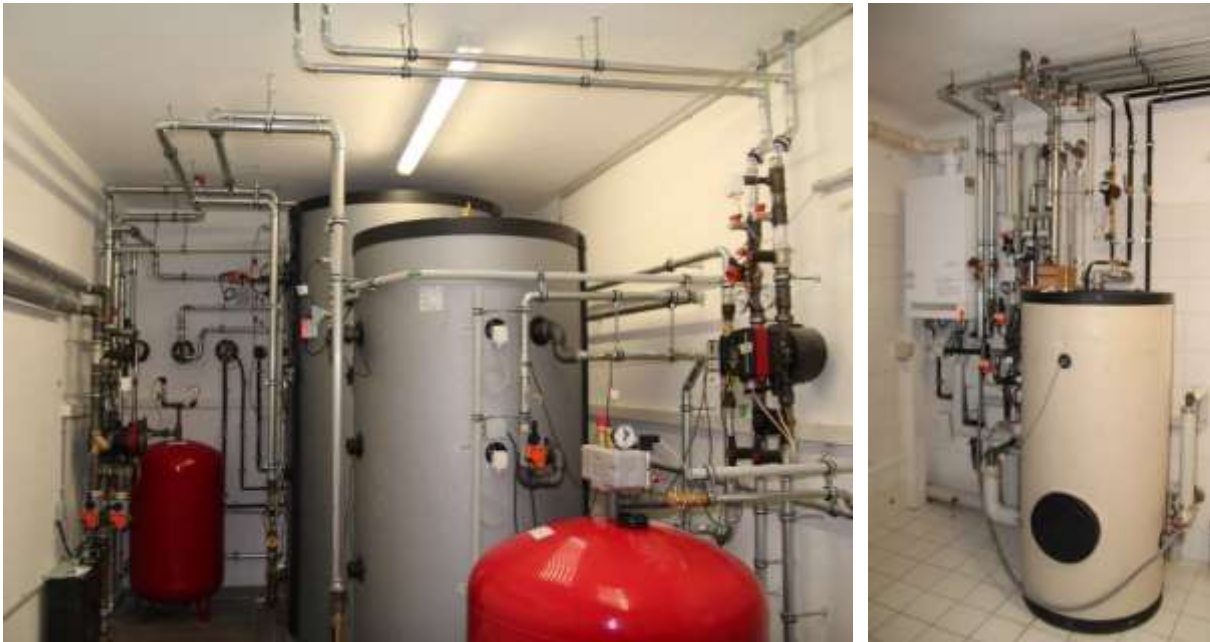
Abbildung 136: Ansicht Technikraum Neu (links) und Bestand (rechts) Pfarrhof St. Martin (Quelle: AIT)
