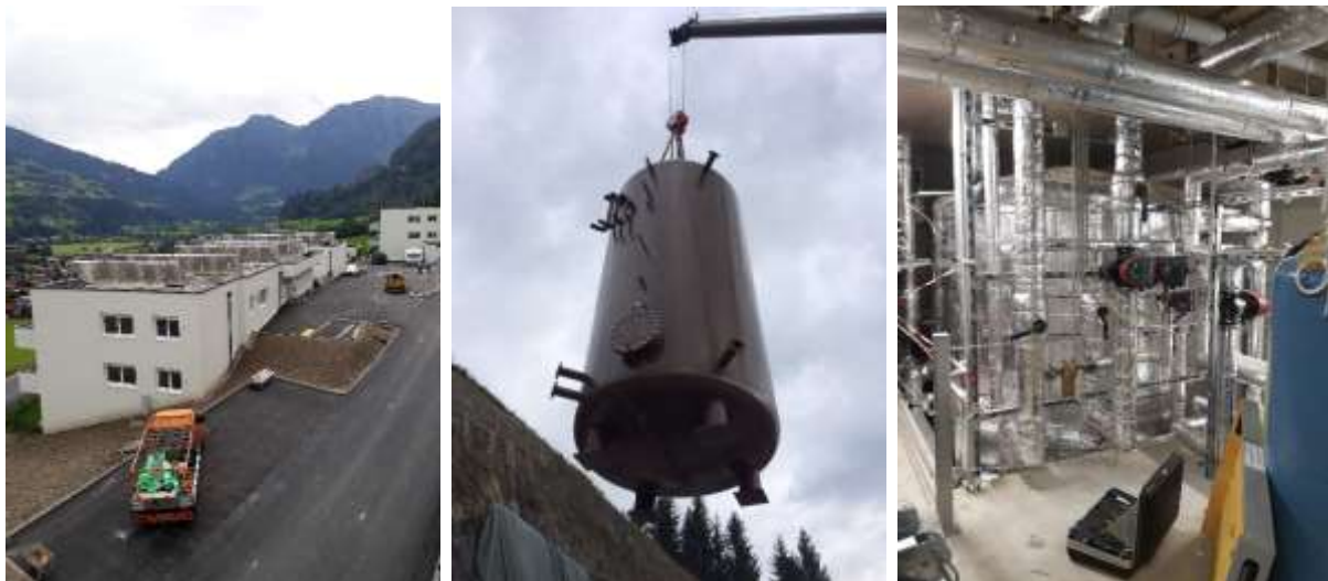
Abbildung 87: Beispiel einer Solarthermieanlage am Dach eines Wohnhauses (links), Pufferspeicher mit 30 m 3 Volumen während der Einbringung in die Heizzentrale (Mitte) und fertig eingebaut und gedämmt (rechts) (Quelle: ENGIE Energie GmbH)
