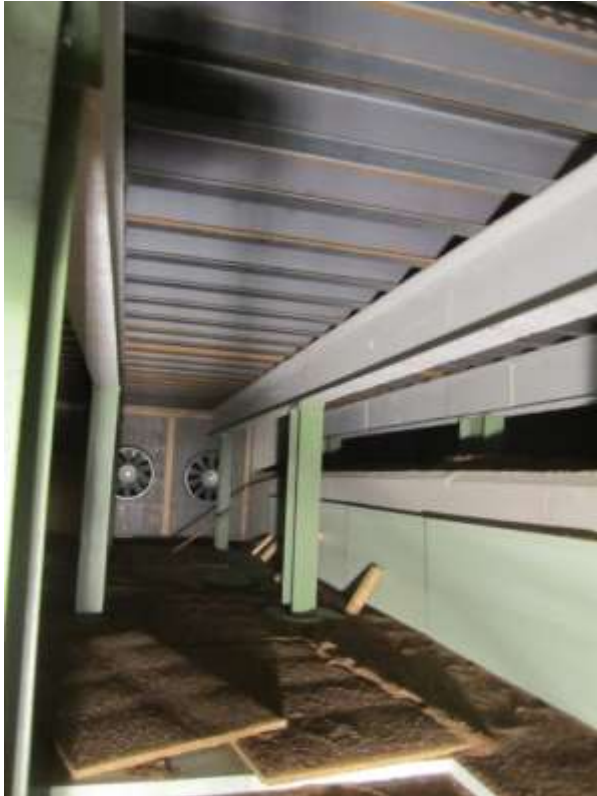
Abbildung 219: Luftverteilschacht unter dem Flachrost mit Ventilatoren (Hintergrund). Quelle: AIT
