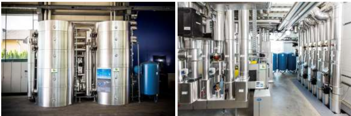
Abbildung 158: Ansicht der beiden Pufferspeicher in der Fassadenbauhalle (linke Darstellung) bzw. Ansicht der Heizzentrale in der „E-Productions Halle“ (Bildquelle: Firma H. Traussnigg GmbH).
