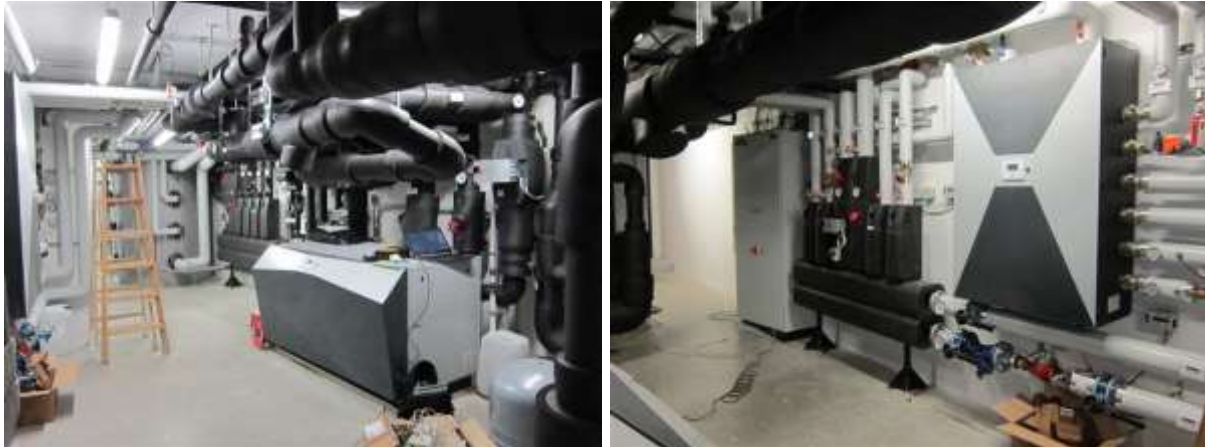
Abbildung 32: Ansicht des Technikraums, der Wärmepumpe (linkes Bild) und der Verteiler sowie des Energy Management System (EMS) (rechtes Bild) (Bildquelle: BES)
