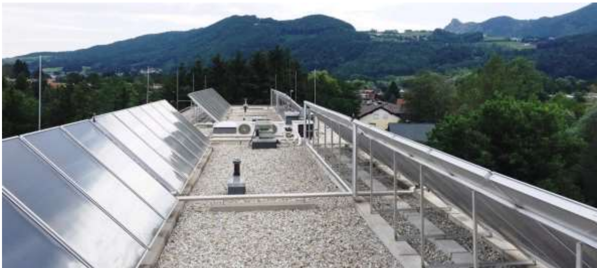
Abbildung 30: Ansicht des gesamten Kollektorfeldes am Dach der r&r-Tischlerei (Bildquelle: r&r-Tischlerei)
