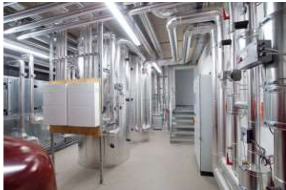
Abbildung 125: Ansicht des Heizraums inkl. der beiden Pufferspeicher des Kultur- und Veranstaltungszentrums Hallwang (Bildquelle: www.kuster.co.at )
