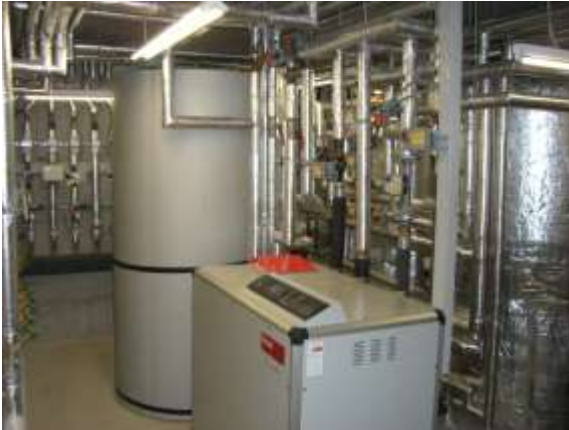
Abbildung 8: Ansicht des Heizraums der Anlage „Brandnertal Gastronomie“. (Bildquelle: Frööd).
