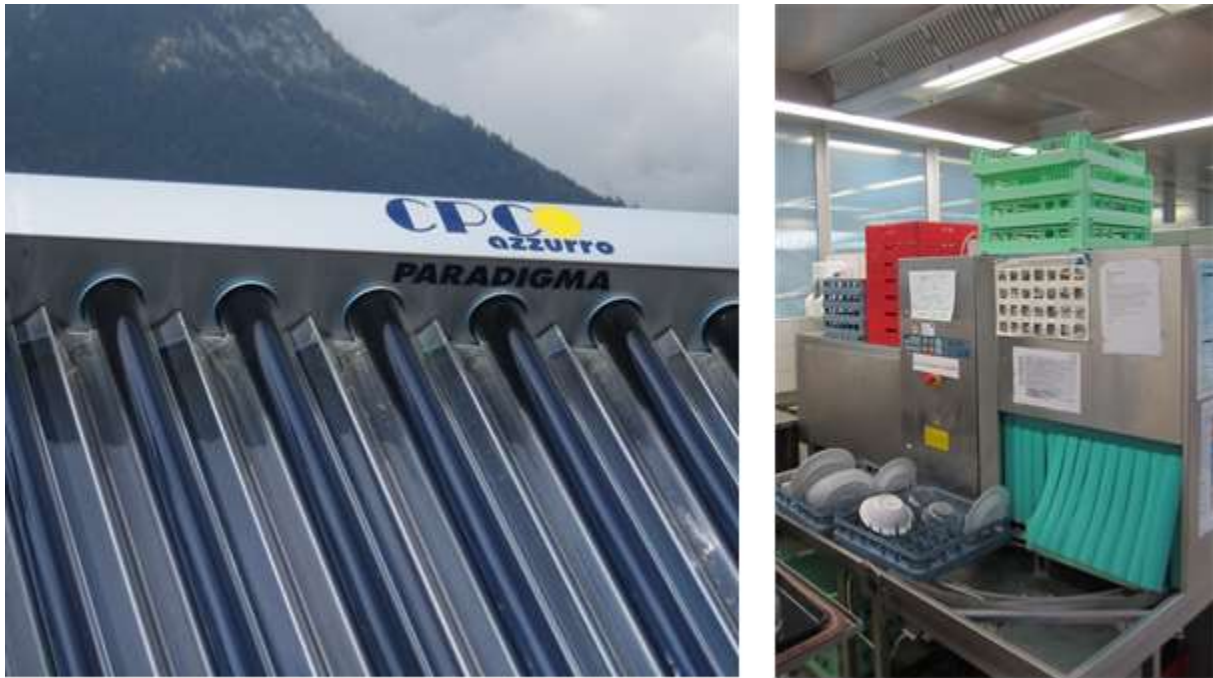
Abbildung 49: Nahansicht CPC-Vakuumröhrenkollektor und Wärmeabnehmer Kantine. Quelle: AIT
