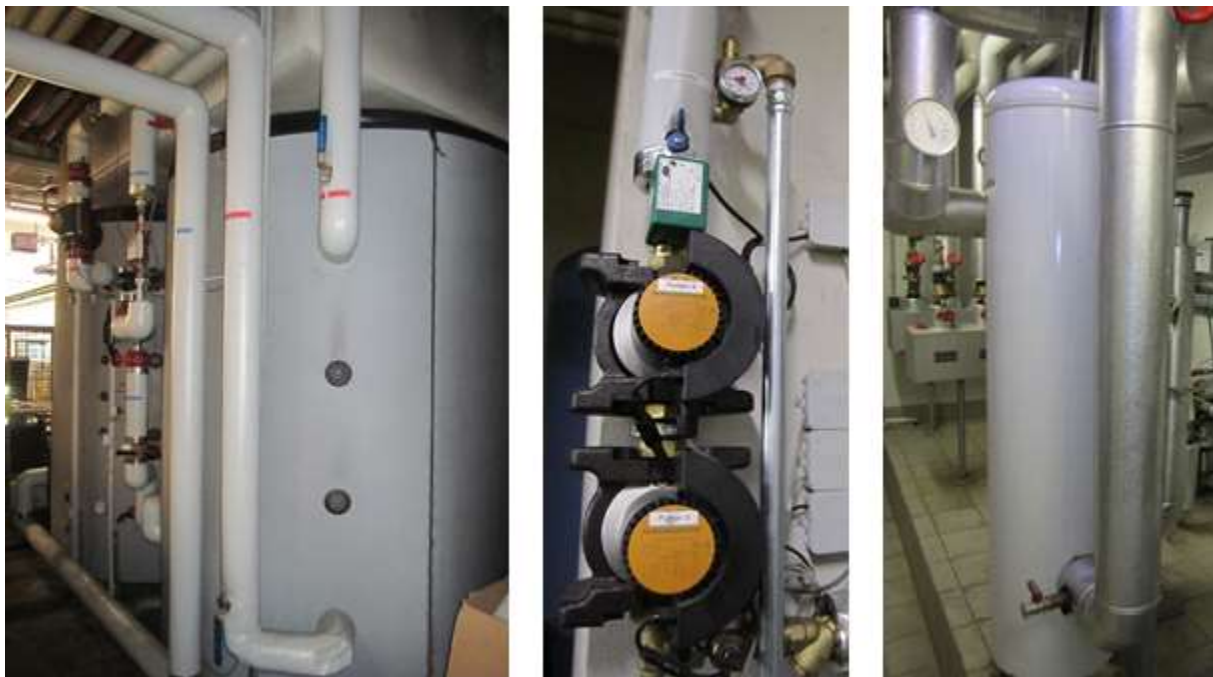
Abbildung 50: Ansicht Speicher (SP1 & SP2), Kollektorpumpen, E-Heizung. Quelle: AIT
