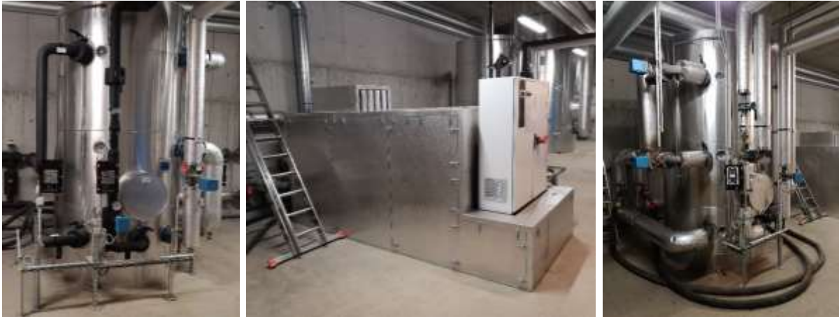
Abbildung 178: Links: Quellspeicher der Wärmepumpe in Heizzentrale 1, Mitte: Wärmepumpe in Heizzentrale 1, Rechts: Senkspeicher der Wärmepumpe in Heizzentrale 1 (Quelle: AEE INTEC)
