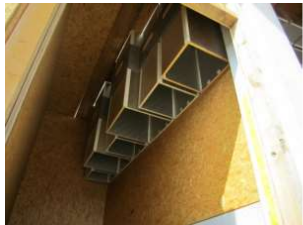
Abbildung 214: Auslassöffnungen der sechs Luftkanäle im Sammelschacht. Quelle: AIT
