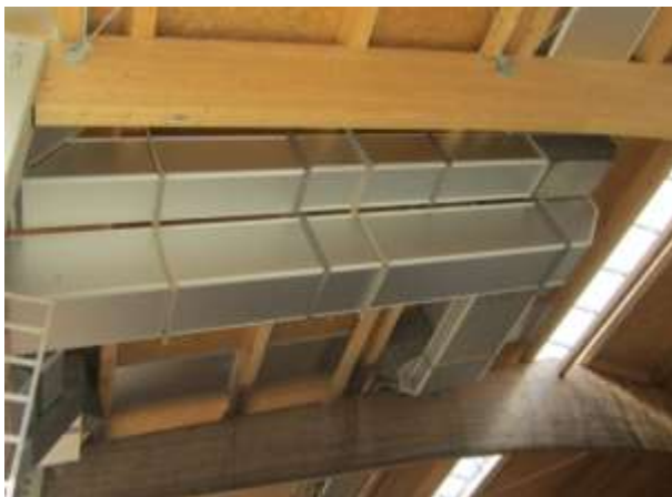
Abbildung 213: Luftkanäle unter der Hallendecke. Quelle: AIT
