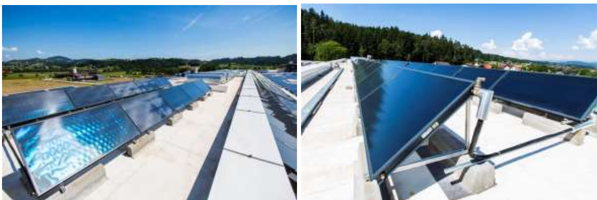
Abbildung 159: Ansicht des Kollektorfelds am Dach des neu errichteten „E-Productions Halle“ (Bildquelle: Firma H. Traussnigg GmbH).
