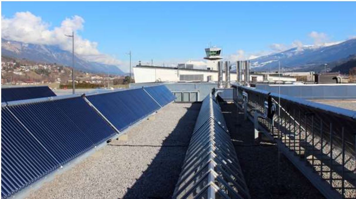
Abbildung 48: Ansicht Solarkollektoren und Tower. Quelle: Fördernehmer
