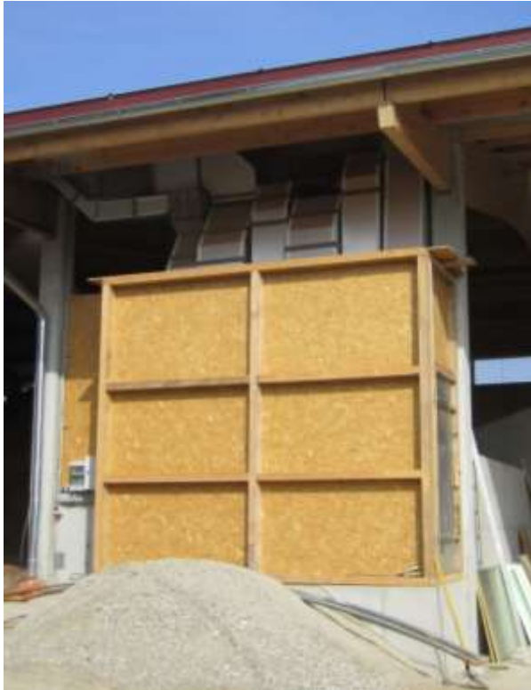
Abbildung 215: Außenansicht des Sammelschachts mit den sechs Luftkanälen (oben), die die Luft von den Kollektoren führen. Quelle: AIT
