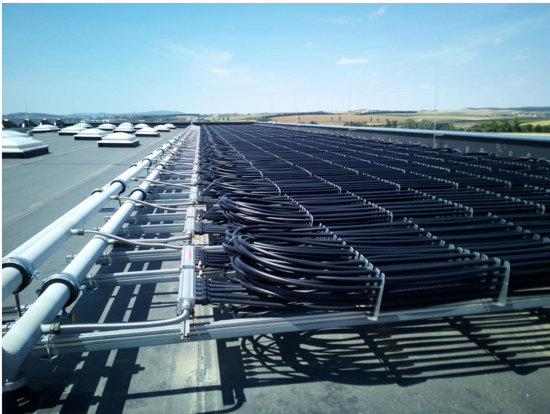
Abbildung 7: Kollektoranlage am Dach der Audio Tuning Vertriebs GmbH (Quelle: AEE INTEC)
