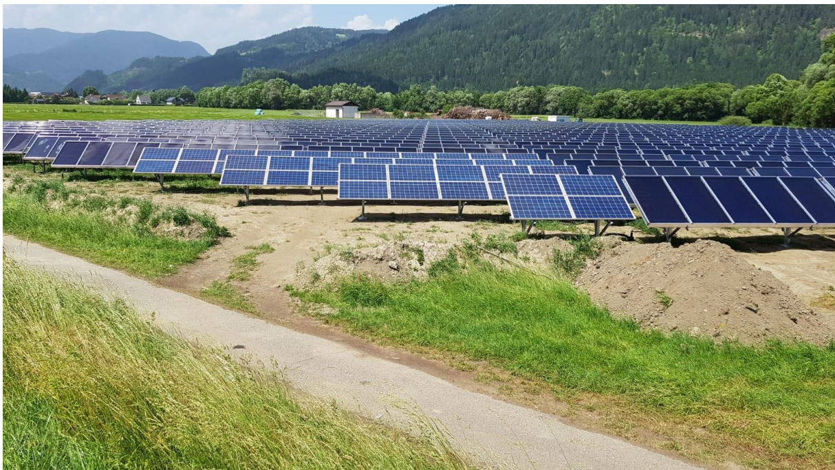
Abbildung 57: Nach der Montage des Solarfeldes, 5.750 m 2 Solarthermie + 25 kWp Photovoltaik zur Erzeugung des Pumpenstroms (Quelle: SolarEngineering Guggenberger)
