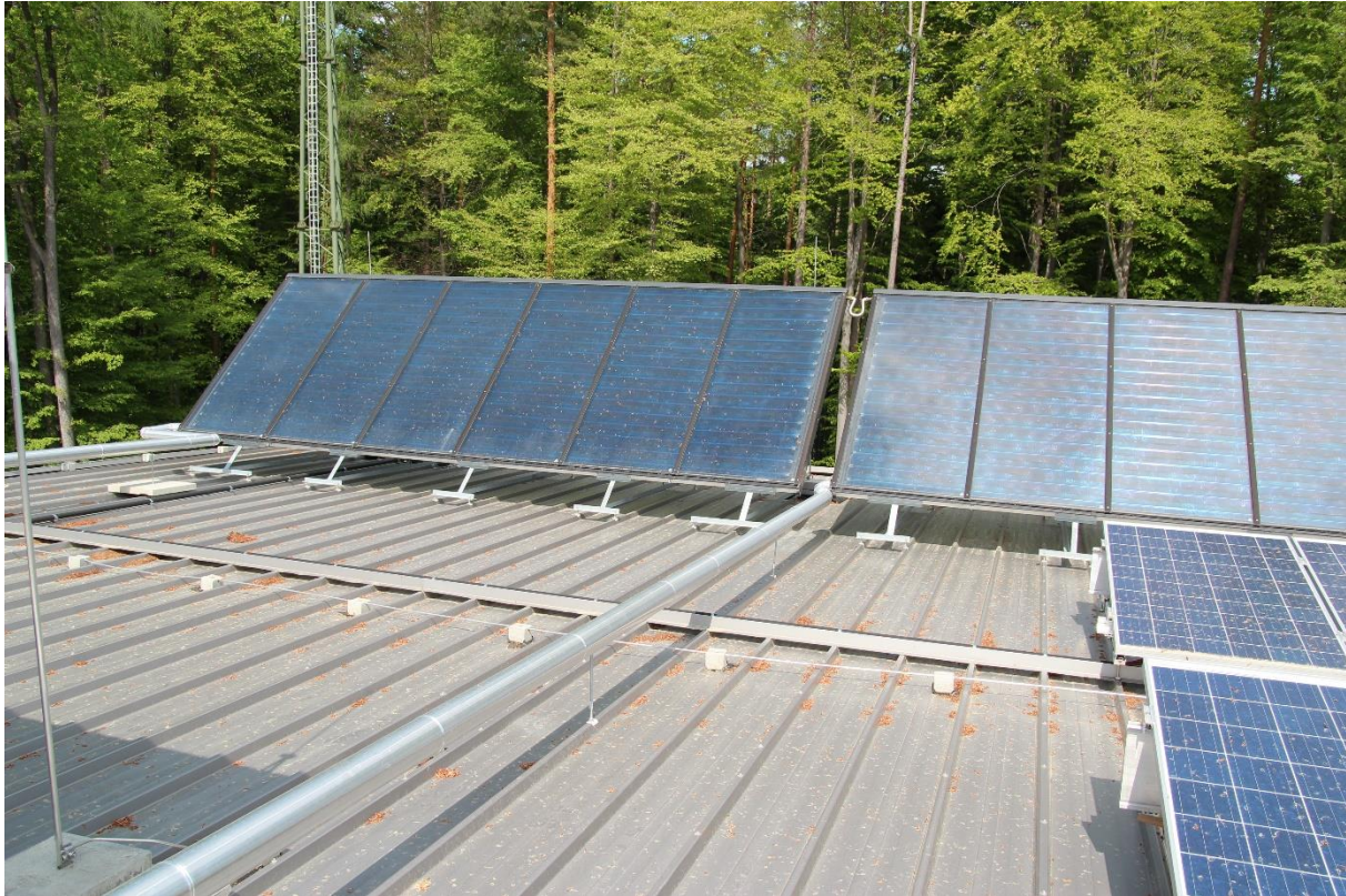
Abbildung 135: Linke Hälfte der hinteren Kollektorreihe der Anlage „Weizer Schafbauern“ (Quelle: AIT).
