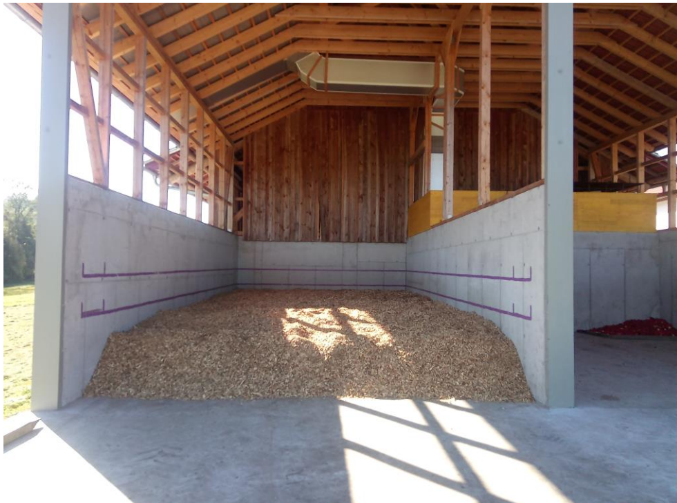
Abbildung 119: Solarleitung vom Dach zu Steinspeicher bzw. Mischkammer; Hackschnitzel auf Flachrost (Quelle: AEE INTEC)
