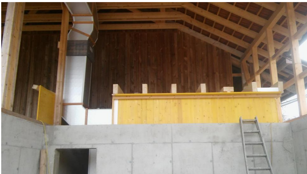
Abbildung 120: Luftkanal in Richtung Steinspeicher/Mischkammer (Quelle: Bauherr)
