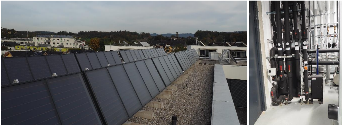
Abbildung 83: Aufgeständerte Solarkollektoren am BORG (links), Heizungskeller Rathaus (rechts) (Quelle: AEE INTEC)
