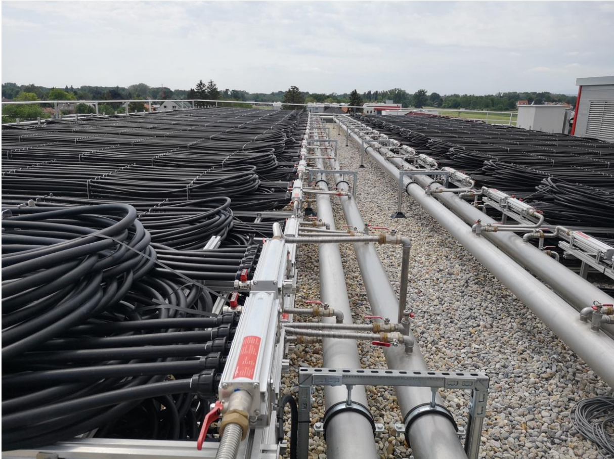
Abbildung 1: Solar-Luft-Kollektor Viessmann SLK-600 am Dach des Firmengebäudes (AEE INTEC).
