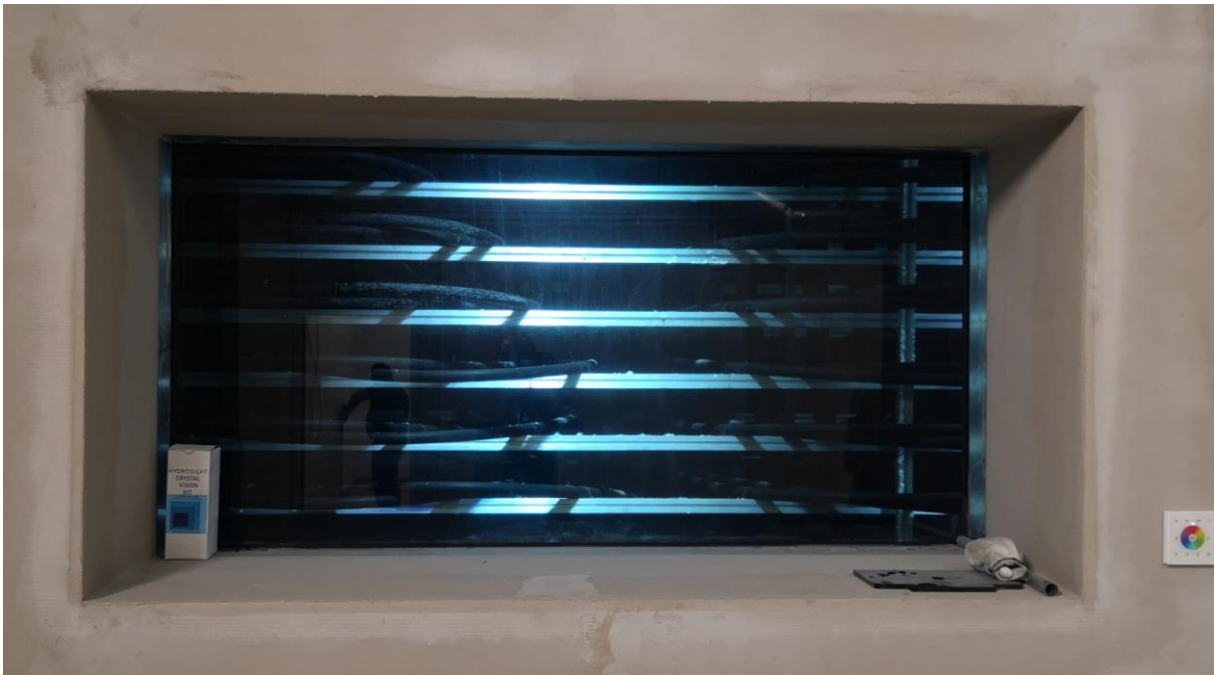
Abbildung 2: Sichtfenster in den Eis-Energiespeicher bei der Anlage Wiegert Fresh (AEE INTEC).
