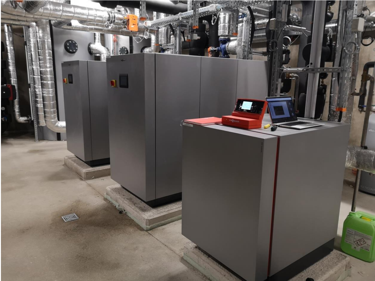
Abbildung 3: Technikraum mit den 3 Wärmepumpen bei der Anlage Wiegert Fresh (AEE INTEC).
