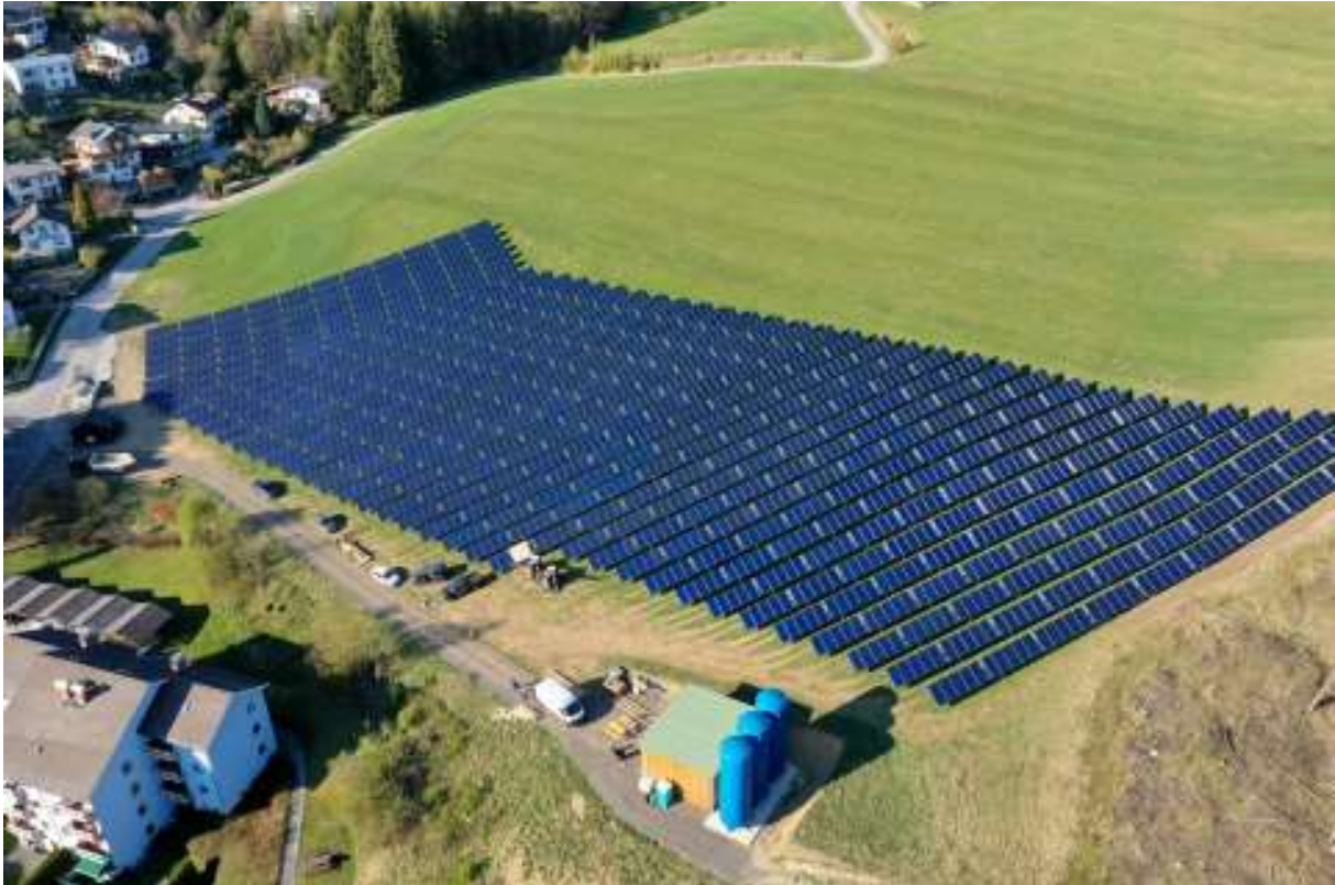
Abbildung 1: Luftaufnahme der Solaranlage mit den drei jeweils 60 m 3 Pufferspeichern im Vordergrund (Quelle: SOLID Solar Energy Systems GmbH)
