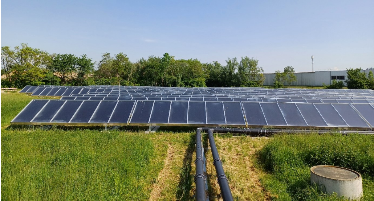
Abbildung 2: Kollektoren des dritten Bauabschnitts.
