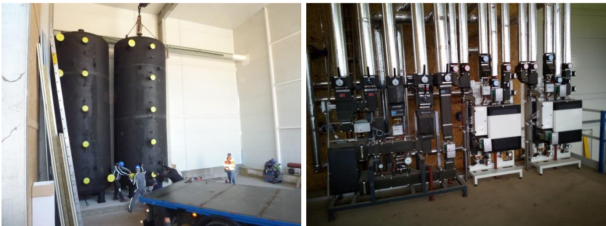
Abbildung 3: Heizzentrale des Projekts „Energieinsel Landskron“. Links: Pufferspeicher. Rechts: Solarstation (Bildquelle: AEE INTEC)
