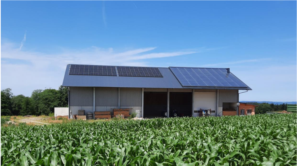
Abbildung 1: Kollektoranlage am Dach der Trocknungshalle (links: Photovoltaik, rechts: Solar-Luftkollektoren) (Quelle: AEE INTEC)
