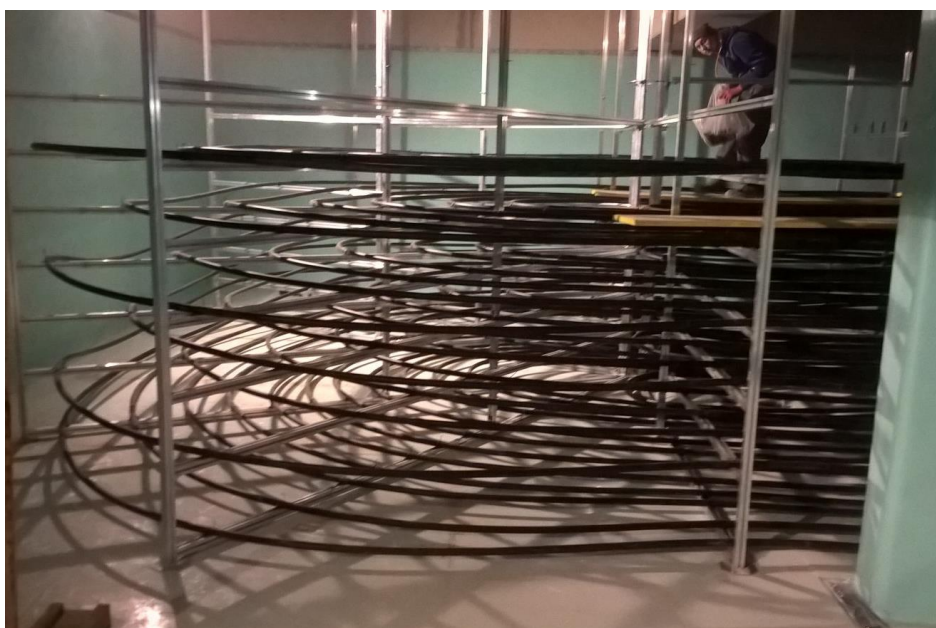
Abbildung 3: Wärmetauscher im Eisspeicher bei Umsetzung der Anlage Audio Tuning Vertriebs GmbH (Quelle: Ökoplan Energiedienstleistungen GmbH)
