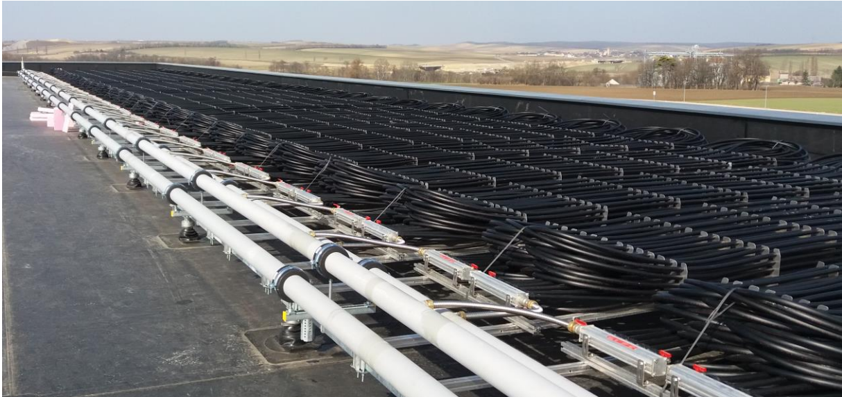
Abbildung 1: Kollektoranlage am Dach der Audio Tuning Vertriebs GmbH (Quelle: Ökoplan Energiedienstleistungen GmbH)
