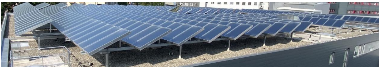
Abbildung 2: Kollektorfeld am Dach der APZ-Halle (Gesamtfläche: 1.295 m 2 ) (Bildquelle: S.O.L.I.D. Gesellschaft für Solarinstallation und Design m.b.H.)
