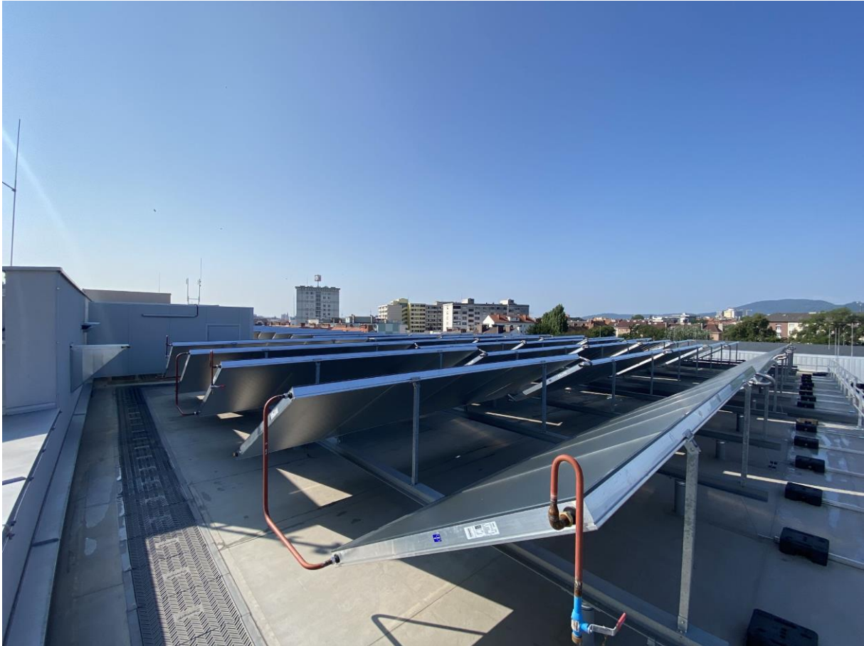
Abbildung 1: Kollektorfeld der Anlage AVL am Dach der Parkgarage (Gesamtfläche: 2.170 m 2 ) (Bildquelle: S.O.L.I.D. Gesellschaft für Solarinstallation und Design m.b.H.)
