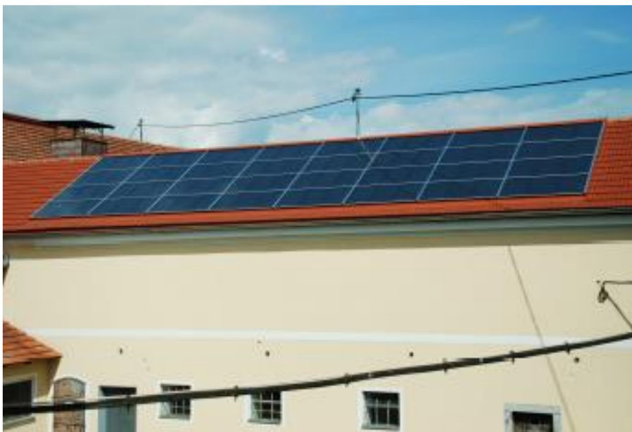
Abbildung 5: Westliches Luftkollektorfeld mit 65,4 m 2 (Quelle: FHOÖ F&E GmbH)
