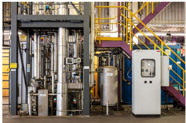
Die Anlage scheidet mithilfe eines Amin-Verfahrens aus den Rauchgasen der Eisenerzeugung Kohlendioxid ab, Foto: voestalpine Stahl GmbH
