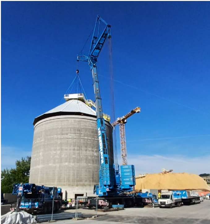
Biomasse-Silo (Außenansicht), Foto: Sappi Austria GmbH
