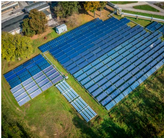
Kollektortest von verschiedenen Kollektortypen mit 3.123 m 2 zur solaren Fernwärmeinspeisung am Fernheizwerk Puchstraße in Graz, Österreich, Foto: S.O.L.I.D.
