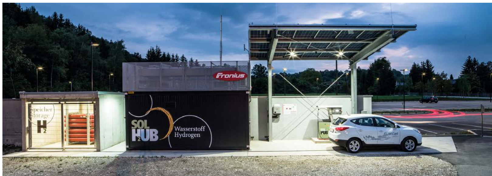
Erste grüne innerbetriebliche Wasserstoff-Betankungsanlage Österreichs, Foto: FRONIUS International GmbH
