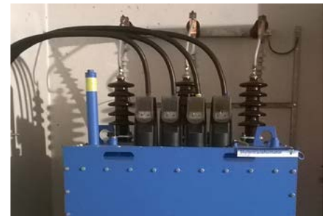
Steuerung und Stufentransformator Köstendorf, beide Fotos: Salzburg Netz GmbH
