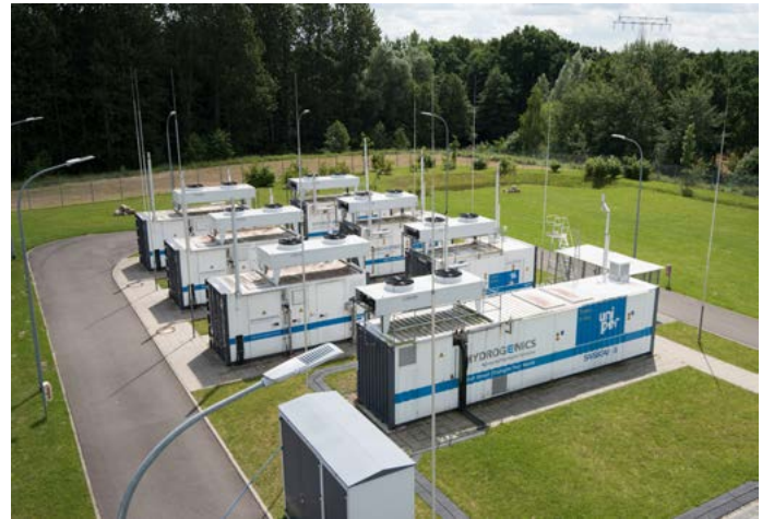
Elektrolyseanlage, Foto: Uniper Energy Storage GmbH
