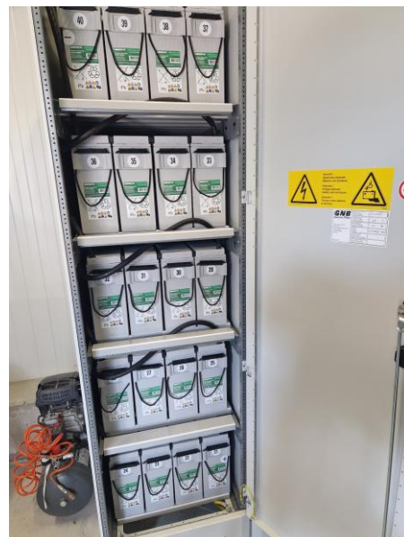
Batterieanlage 40 x M12F190PC
