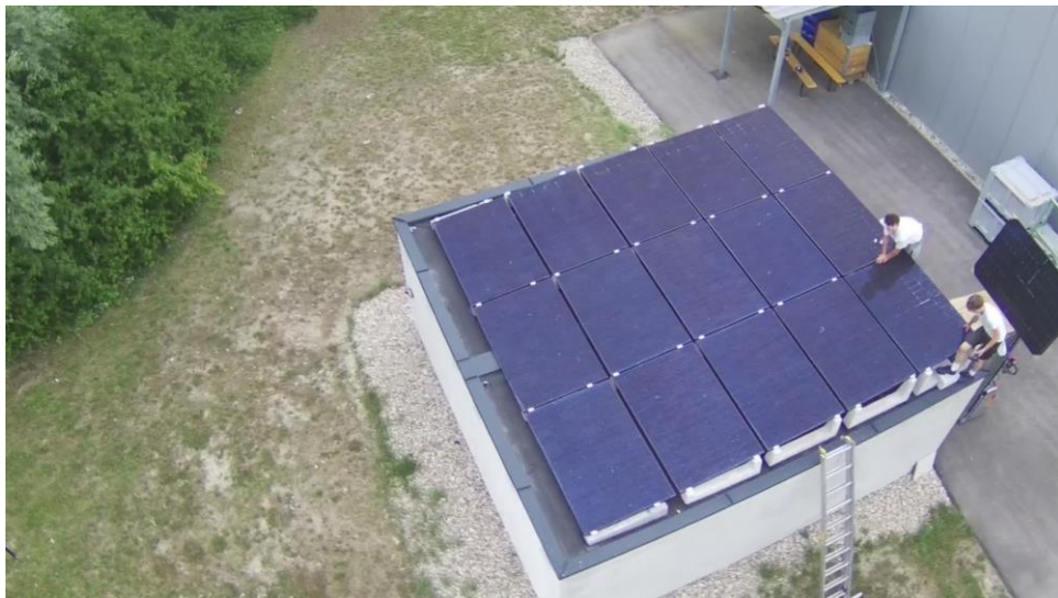
Garage – Segeldach – 15 Module – 440 Wp
