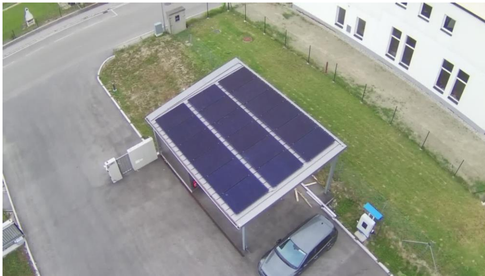
USV + Energiespeicher Schuppen – 18 Module -440Wp
