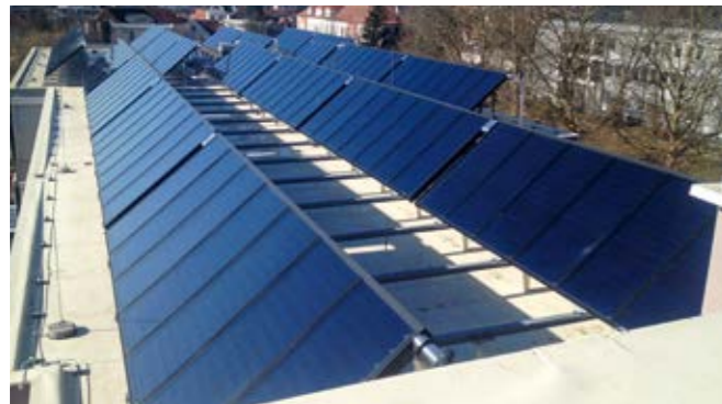
Berechnet für das gesamte Fernwärmenetz ergibt sich für die Solaranlage am Dach der „Neuen Mittelschule“ ein jährlicher solarer Deckungsgrad von 1,46 Prozent.
