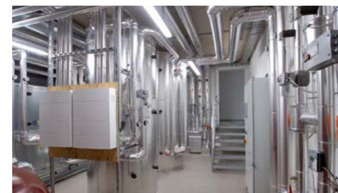
Die Solaranlage im Kultur- und Veranstaltungszentrum Hallwang – hier der Heizraum – ist österreichweit einzigartig
