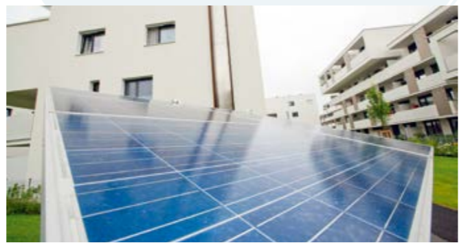
Die schwenkbare PV-Anlage der Wohnanlage ROSA ZUKUNFT
