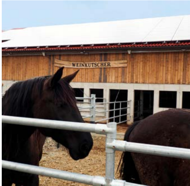
Auch am Dach des Pferdestalls wurde eine PV-Anlage installiert
