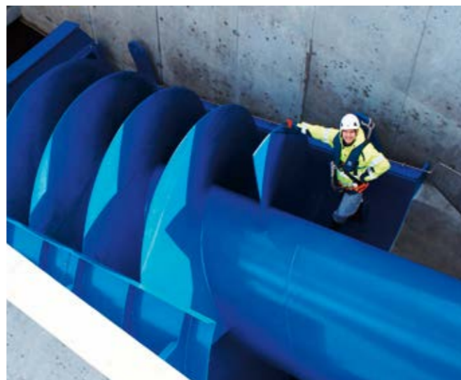
Wasserkraftschnecke in der ebswien Hauptkläranlage
