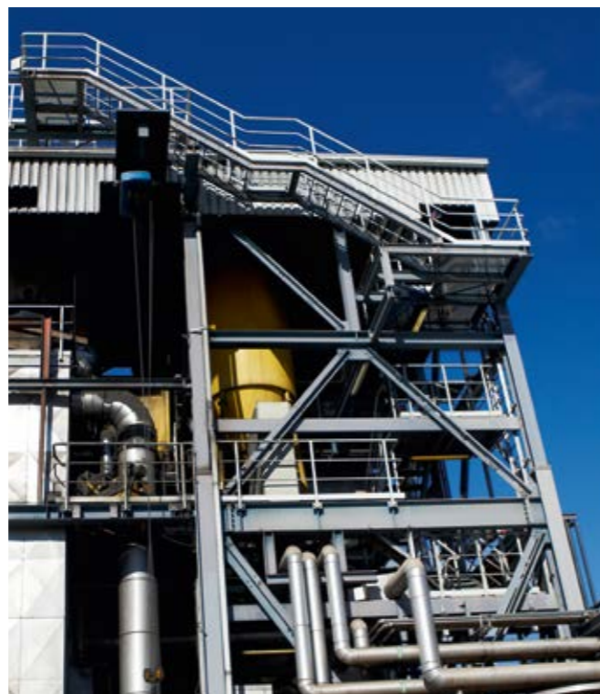
Biogasanlage im ökoEnergieLand Güssing
