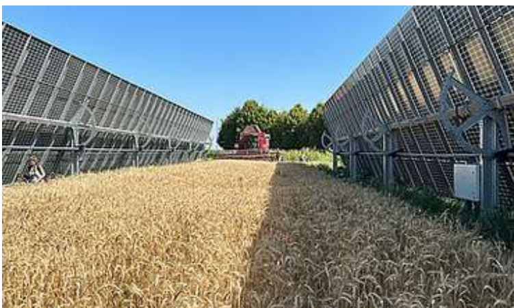
Im Erntemodus sind die Modultische weit aufgeklappt und sorgen für eine hohe Durchfahrtslichte, damit der Mähdrescher problemlos durchkommt.
